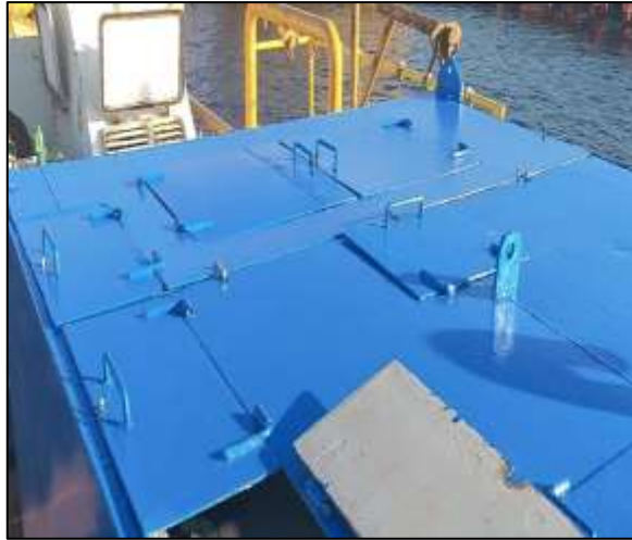
Figura 23 Estado posterior: Pintado en color celeste oscuro (3era capa 4-4-2) de las tapas principales y auxiliares de PTAR
