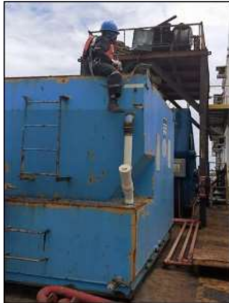
Figura 1 Desajuste de pernos para el retiro de tapa principal de PTAR
