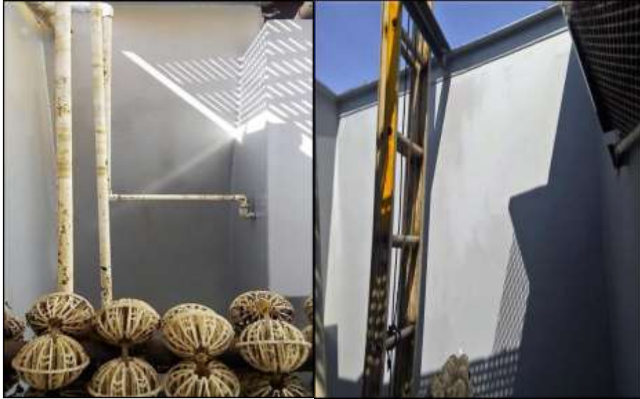
Figura 15 Estado posterior: Pintado acabado en color gris de las paredes internas de PTAR
