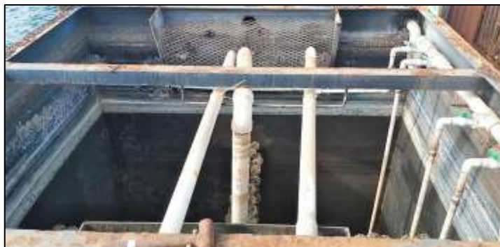
Figura 6 Tubería de inyección de aire
