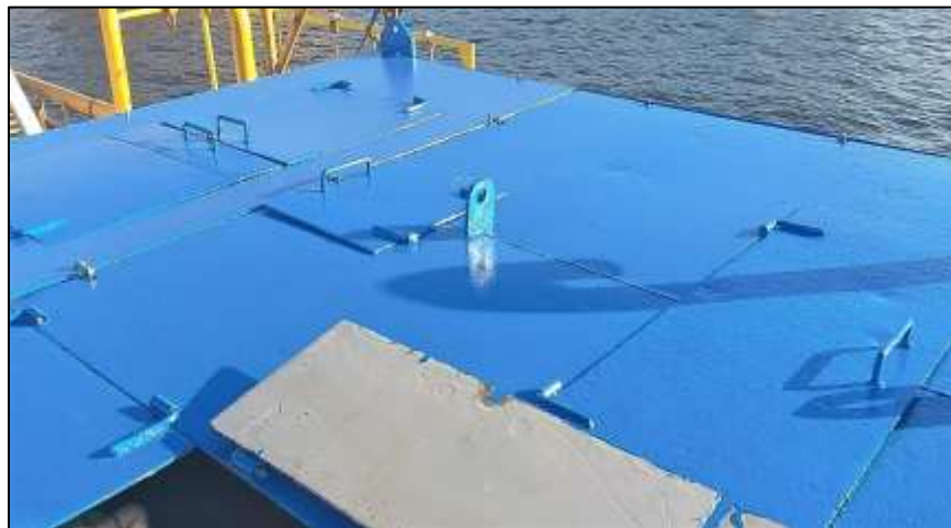
Figura 24 Montaje de tapa principal y auxiliares (empernado y ajuste) de la Planta de Tratamiento
