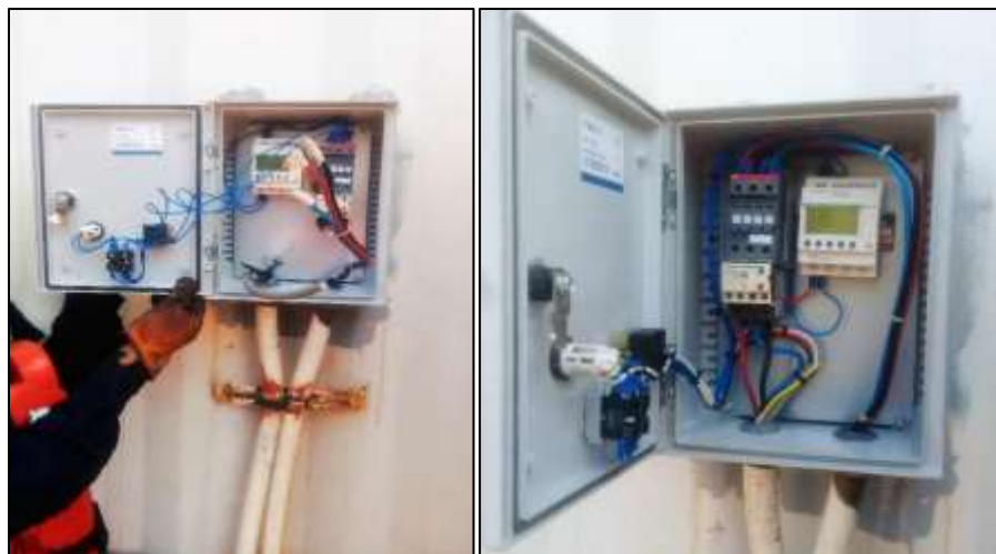
Figura 8 Instalación de módulo e interruptor para el manejo operativo de la Planta de Tratamiento
