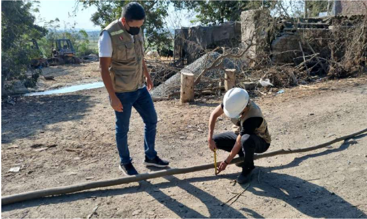
Imagen N° 11: Presencia de baches en la progresiva 2+542.80 al 2+579.00
