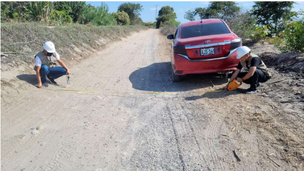
Imagen N° 16: Presencia de agregado suelto en la progresiva 3+271.46 al 3+307.00
