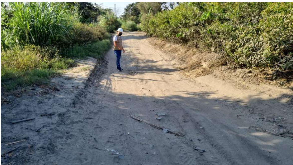
Imagen N° 12: Presencia de baches y agregado suelto en la progresiva 2+542.80 al 2+579.00
