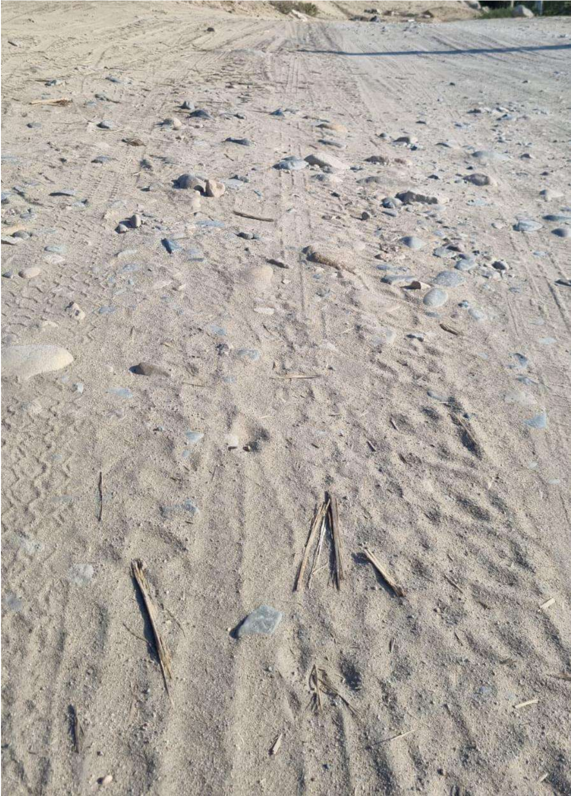
Imagen N° 10: Presencia de agregado suelto en progresiva 2+171.80 al 2+218.00
