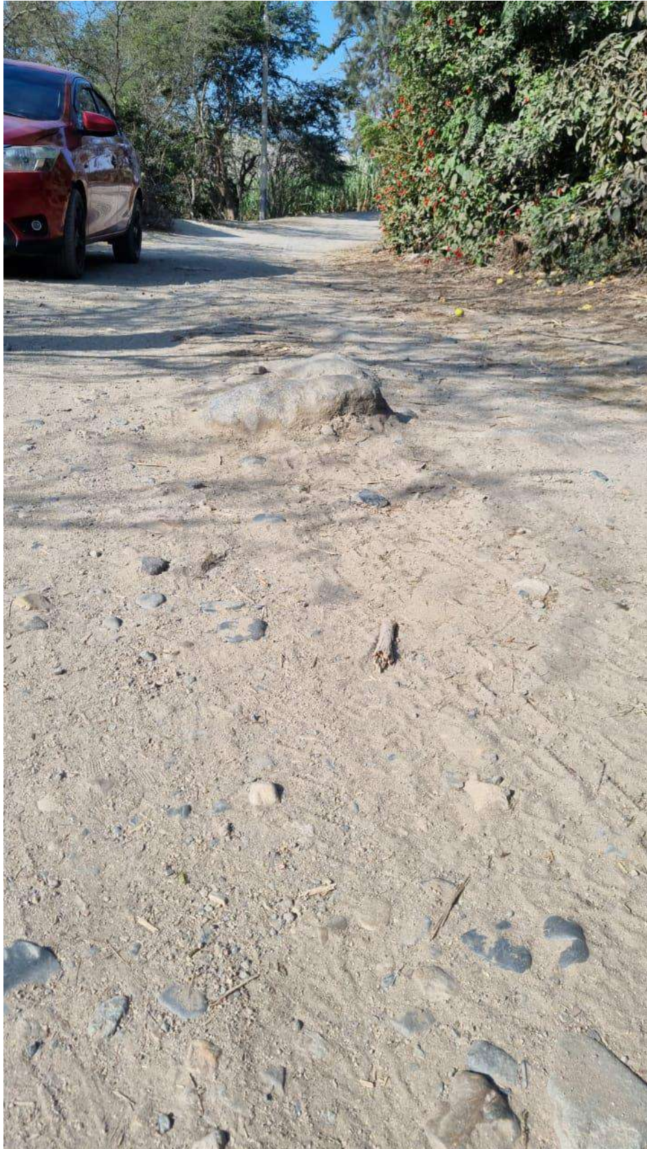
Imagen N° 13: Presencia de agregado suelto en la progresiva 2+542.80 al 2+579.00
