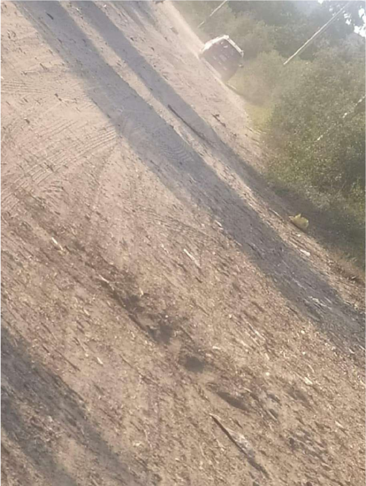
Imagen N° 06: Presencia de polvo y baches en progresiva 1+654.22 al 1+697.00
