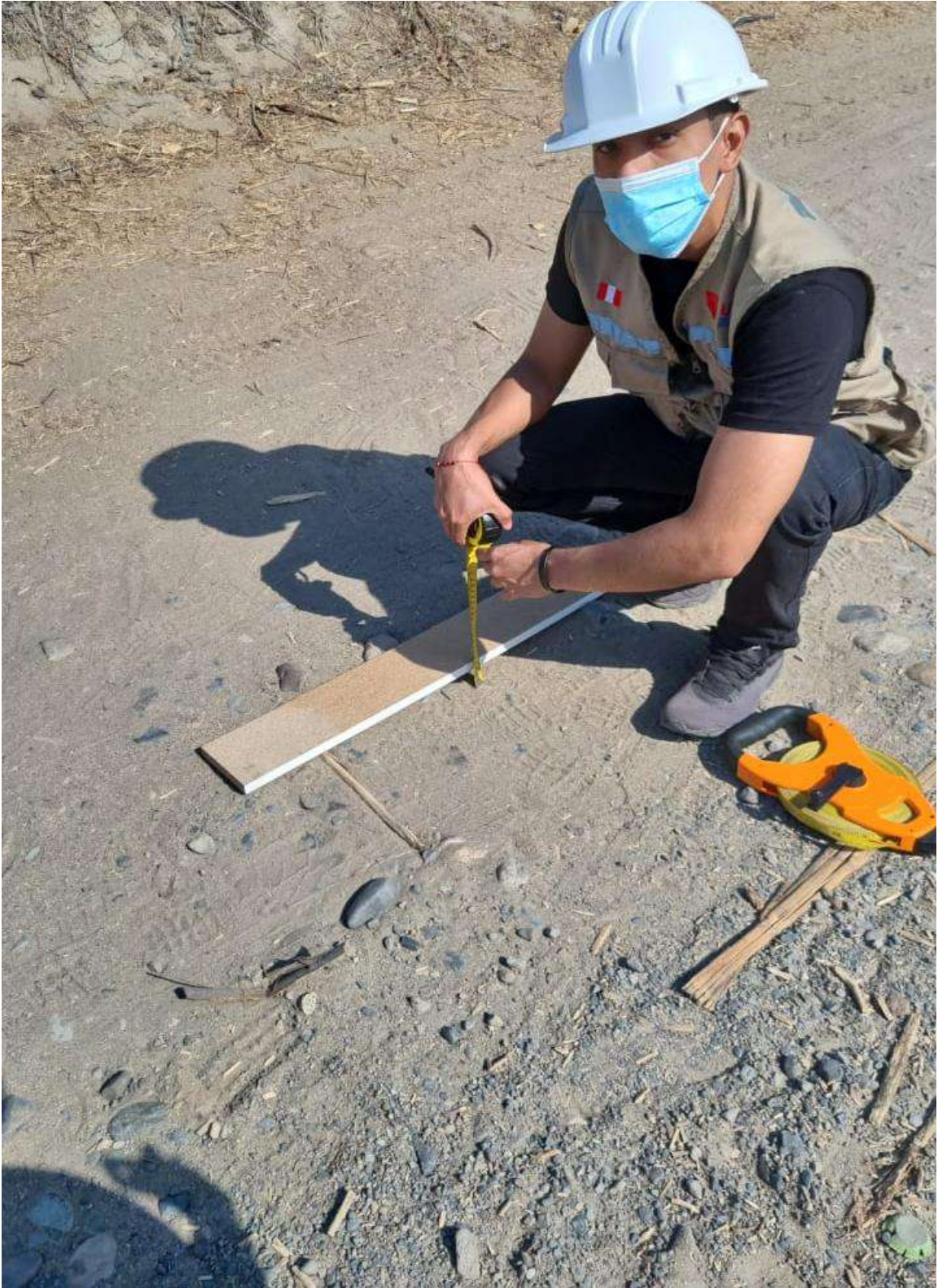
Imagen N° 18: Presencia de baches en la progresiva 3+900.39 al 3+964.56
