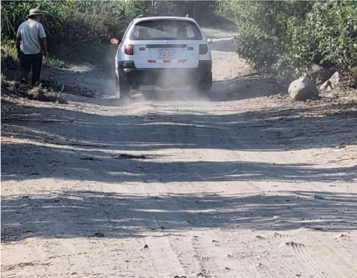
Imagen N° 15: Presencia de polvo en la progresiva 2+542.80 al 2+579.00
