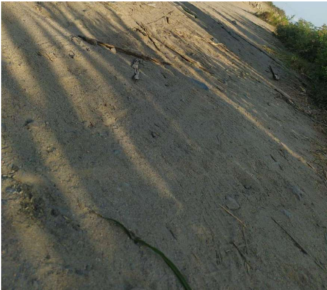
Imagen N° 05: Presencia de baches en progresiva 1+654.22 al 1+697.00
