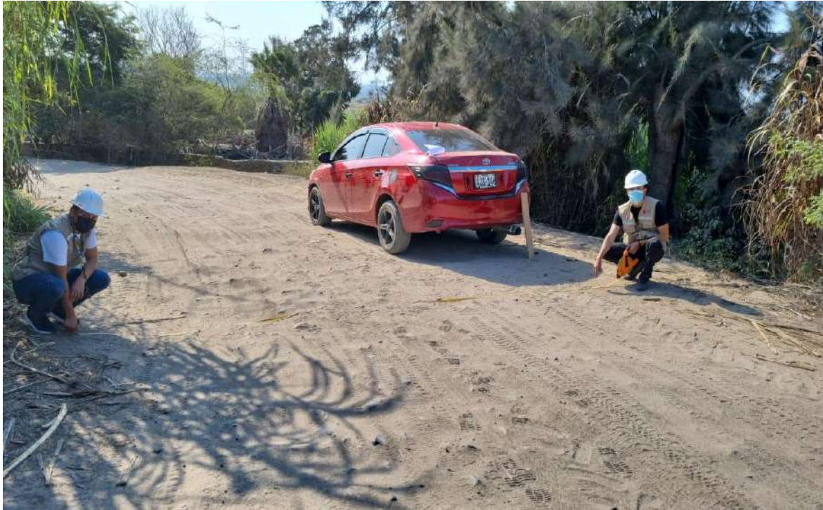
Imagen N° 19: Presencia de agregado suelto en la progresiva 3+900.39 al 3+964.56
