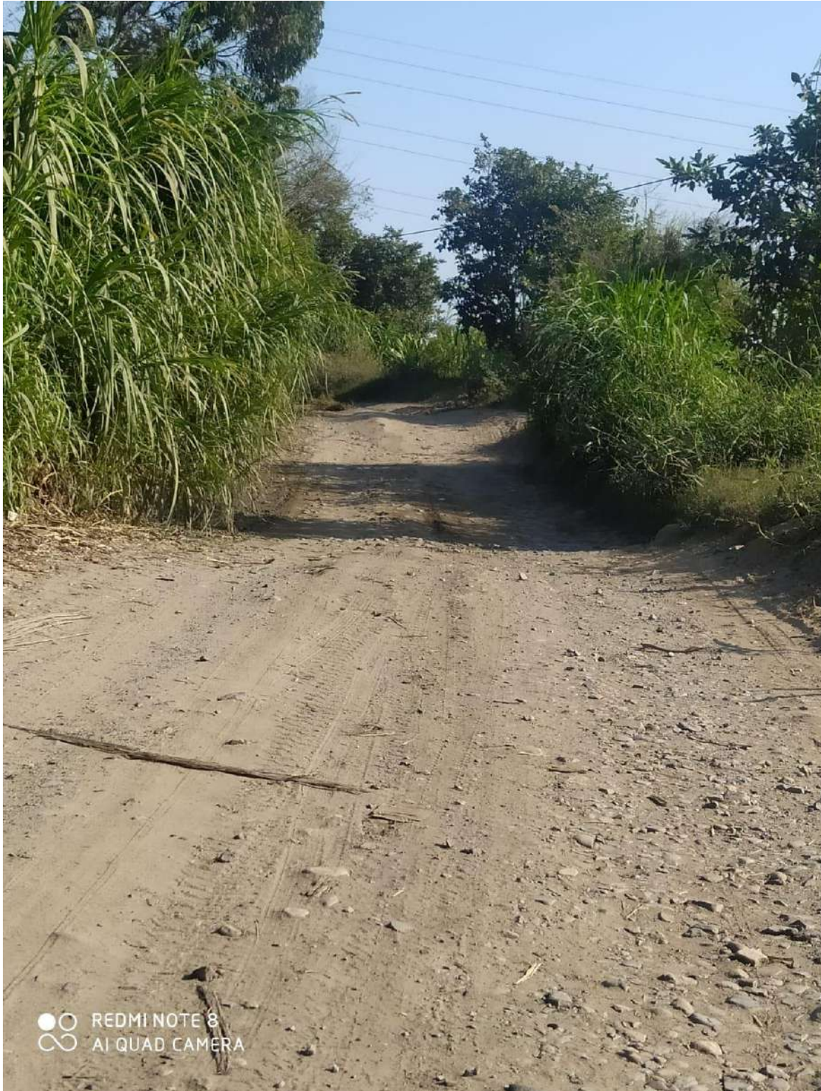
Imagen N° 07: Presencia de baches y agregado suelto en la progresiva 2+171.80 al 2+218.00
