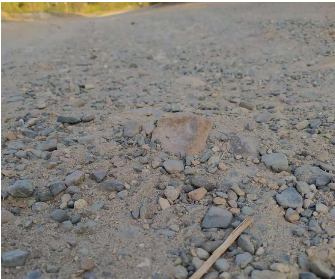
Imagen N° 02: Presencia de agregado suelto en progresiva 0+474.80 al 0+521.00
