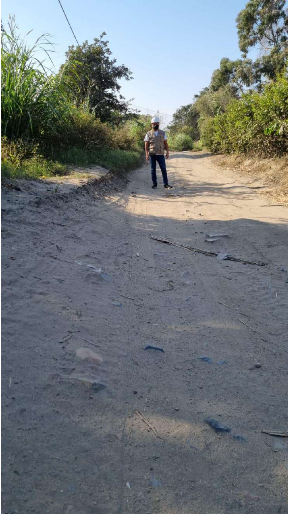
Imagen N° 14: Presencia de surcos en la progresiva 2+542.80 al 2+579.00
