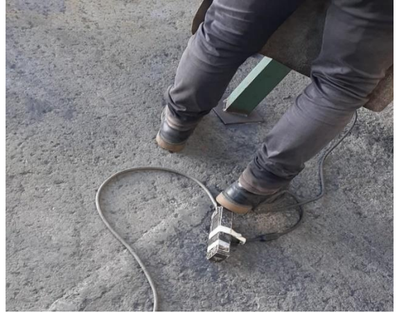
Figura 8: Se evidencia el uso incorrecto de conectores de corriente ya que los domésticos pueden ocasionar daños en las instalaciones
