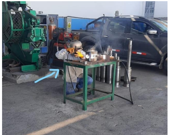
Figura 7: Se evidencia que el operario no utiliza todos los EPP específicos para soldadura ocasionando posibles quemaduras corporales
