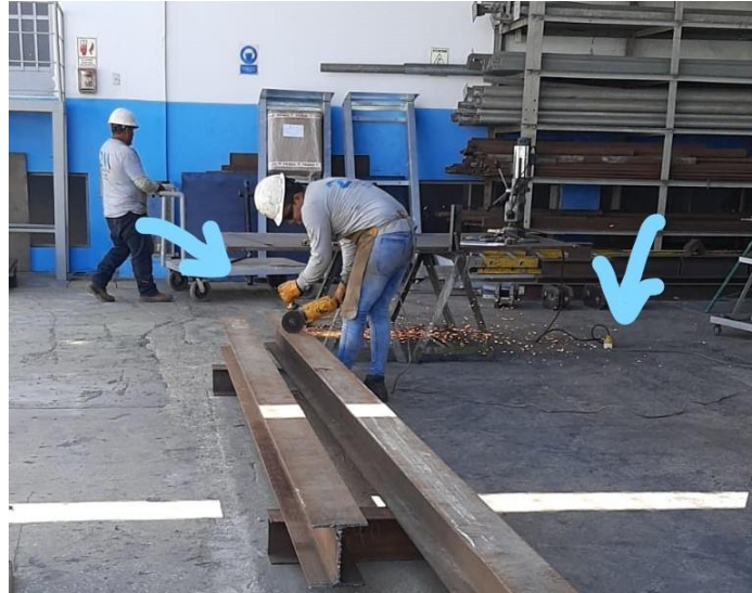
Figura 2: No se presenció el uso de guarda de seguridad en el esmeril, ni uso de biombos de seguridad en la actividad de
