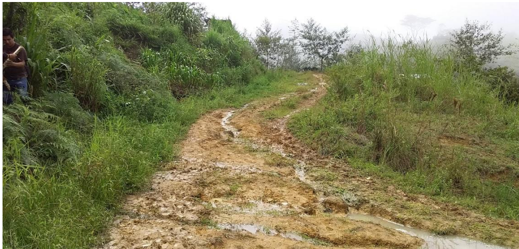
Fotografía N°07: Tramo crítico de la carretera en estudio.
