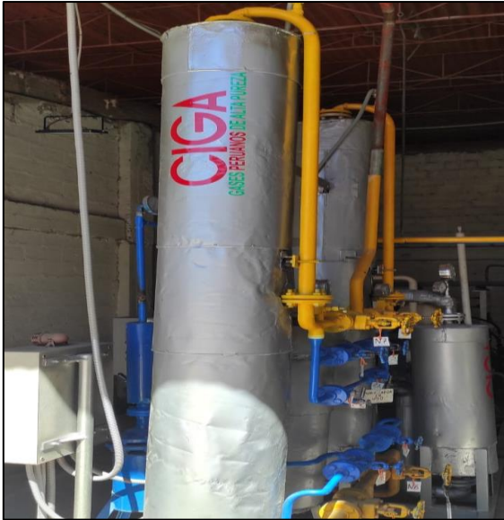
Figura 13: Purificadores de aire
