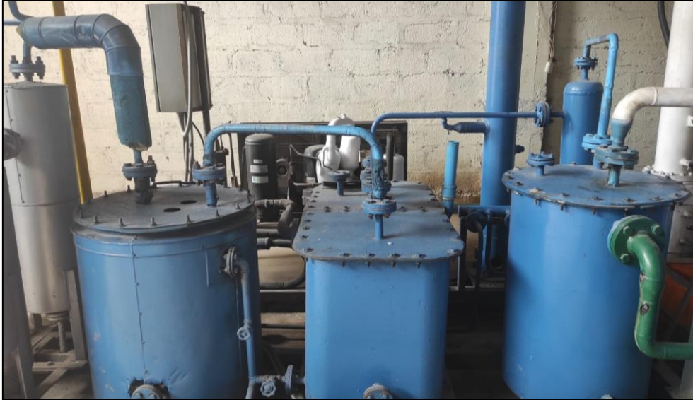
Figura 12: Primer intercambiador de temperatura
