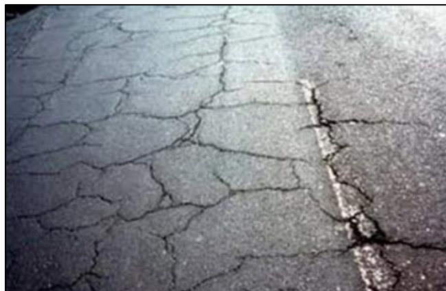
Figura 3. Falla de pavimentos
