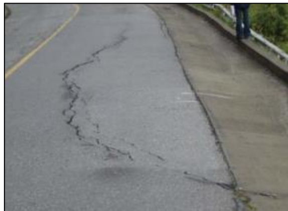
Figura 13. Fisura en arco
