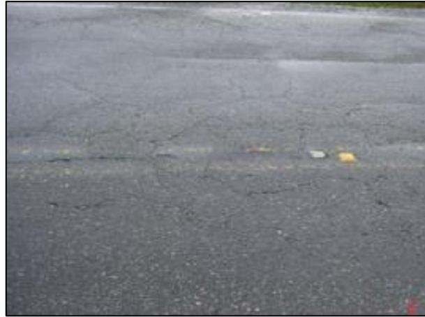
Figura 11. Fisura en bloque
