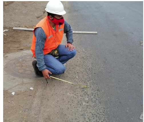
Fotografía 52. Medidas de fallas
