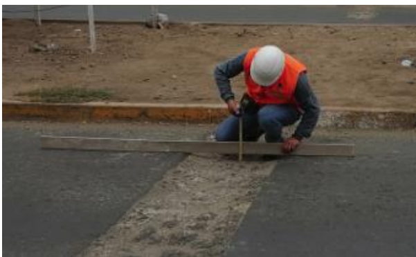
Fotografía 53. Falla en Parches
