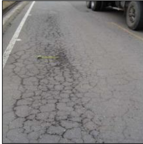
Figura 12. Fisura tipo piel de cocodrilo
