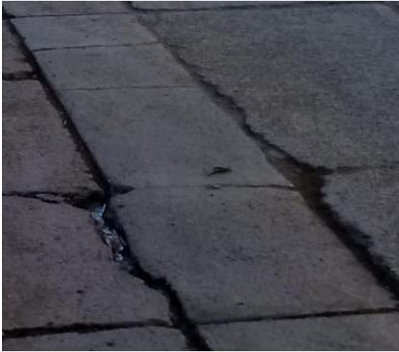
Figura 11 Descascaramiento de junta.
