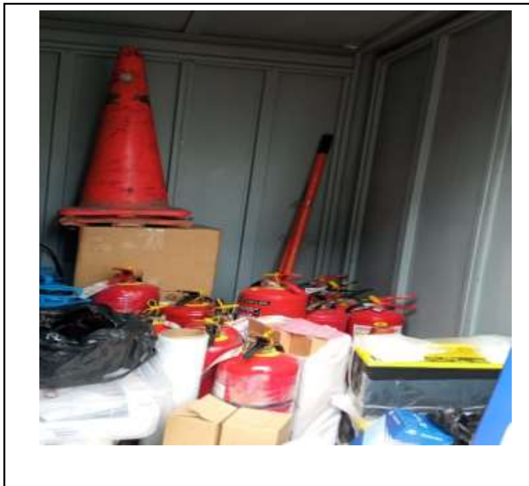
Figura 30 Zona de Almacén desordenada - otros
