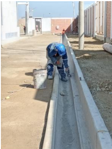
Uso de equipos sin autorización
