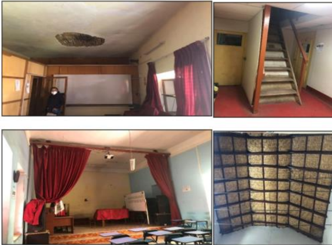
Gráfico N° 02: Condiciones Actuales de la Infraestructura de la ESFA – Condorcunca Ayacucho
