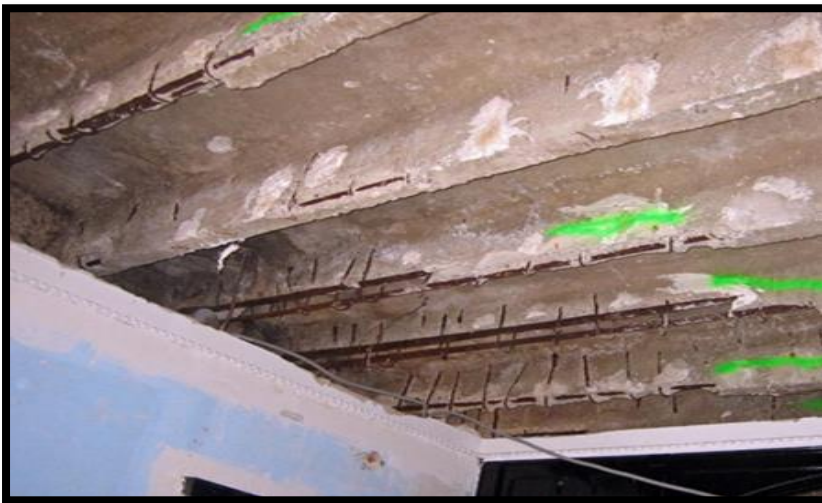
figura 4.falla de vigas por flexión o por corte de apoyo
