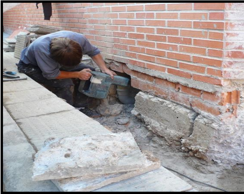
figura 3.falla de cimentaciones ocasionadas por características del terreno
