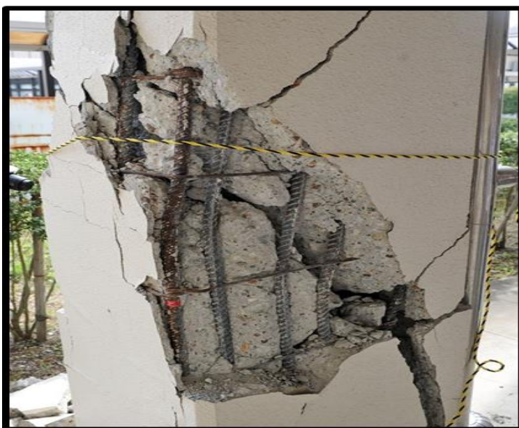
figura 5.falla en columnas por compresión o falla por cortante
