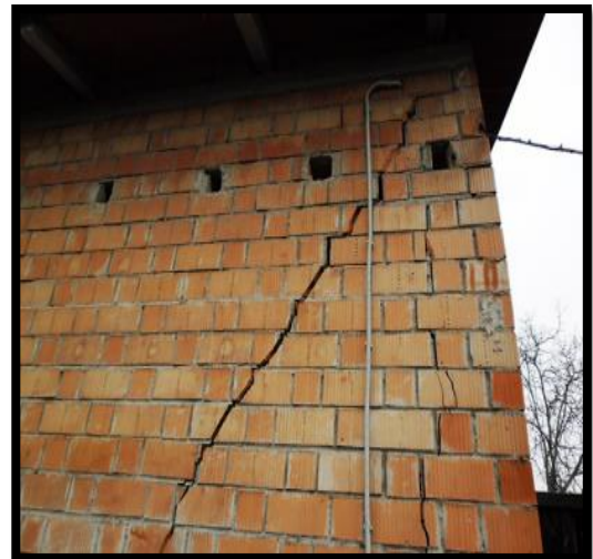
Figura N°2. Muro afectado por asentamiento
