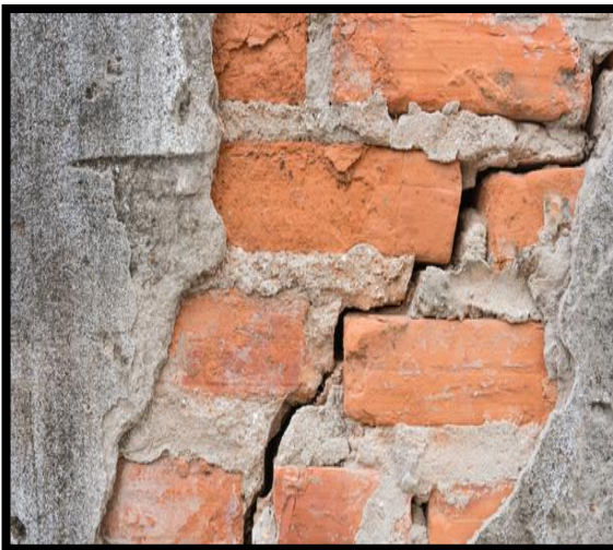
Figura N°1. Muro afectado por fuerza sísmica
