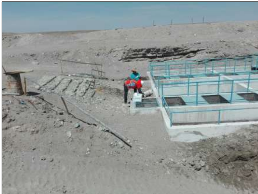
Caja de ingreso al Tanque IMHOFF
