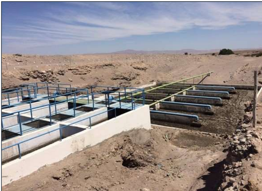
Vista de la planta de tratamiento
