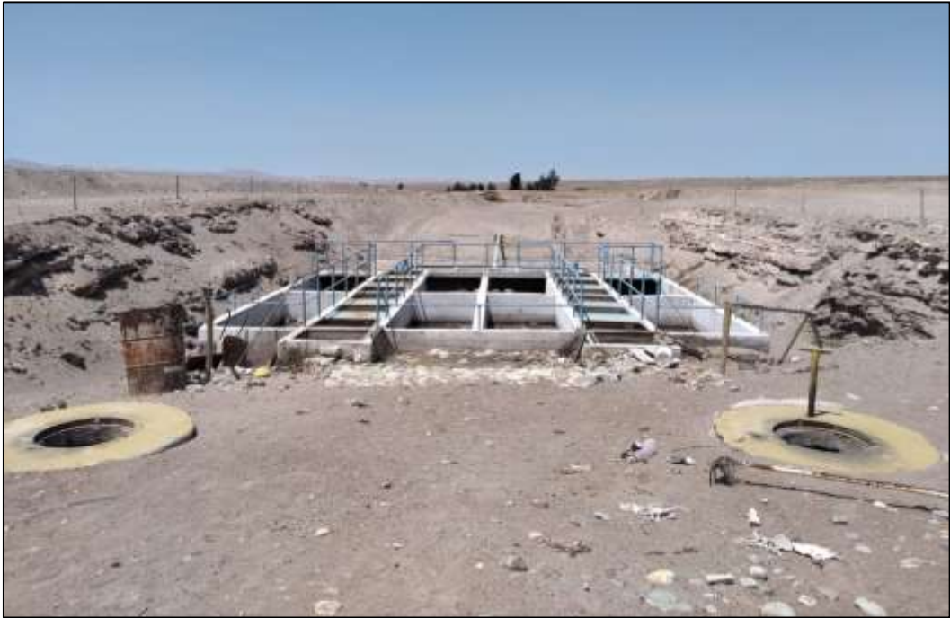
Tanque IM-HOFF (02 unidades)
