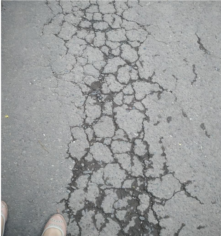
Fotografía N° 03. DESPRENDIMIENTO DE AGREGADOS
