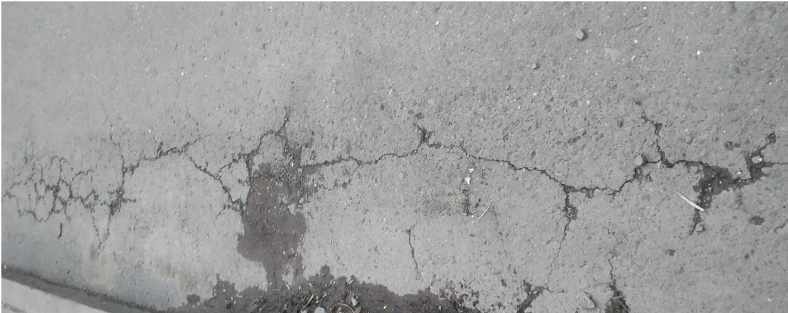
Fotografía N° 09. GRIETAS LONGITUDINALES Y TRANSVERSALES
