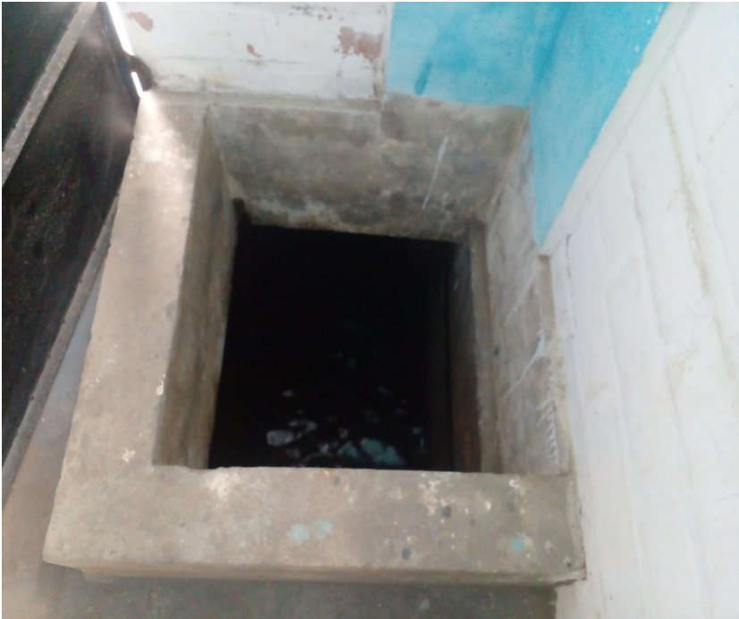
TANQUE DEL BOMBEO DE 60 M3
