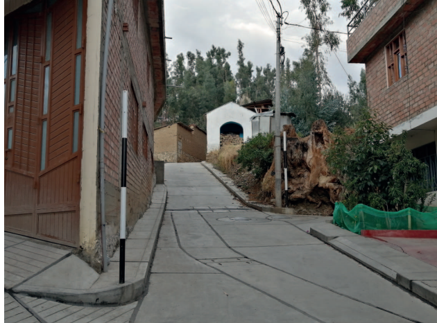
Señalización sin implementar desde la finalización de obra en febrero de 2021 en el pasaje El Aguajal
