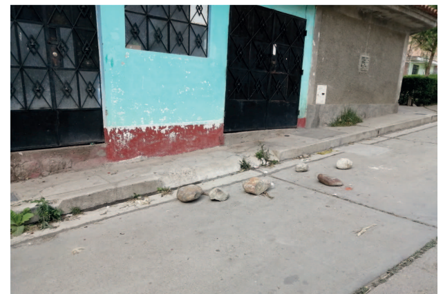
Veredas con piedras a los lados, piedras pequeñas en su superficie y desgaste en su estructura
