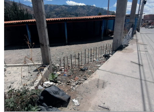
Circulación peatonal limitada por fierros incrustados en la pista, otros expuestos entre las columnas y plataformas de concreto
