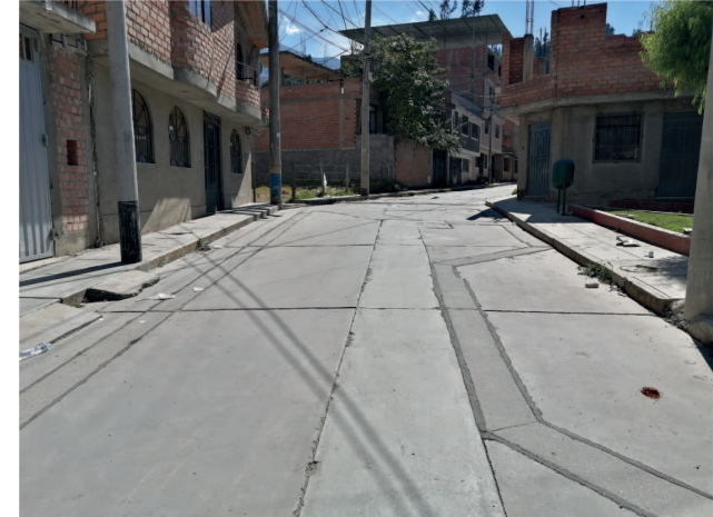
Tramo de la pista con cortes por instalaciones de gas natural, desechos a los lados y rampas vehiculares
