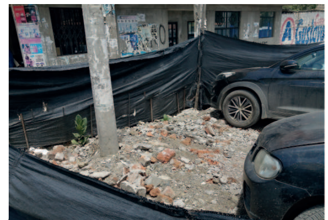
Sector del estacionamiento exterior del segundo ingreso del Gobierno Regional que forma parte de las obras abandonadas de la fachada utilizadas como botadero de desmote y desechos
