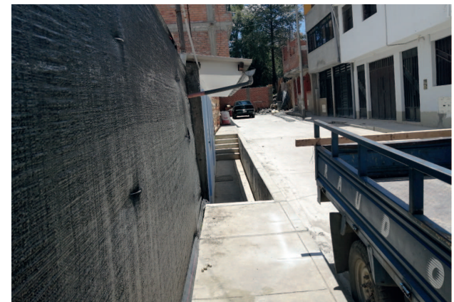
Adaptación de las veredas en el pasaje sin nombre debido a la depresión en la que se encuentra el ingreso hacia un predio
