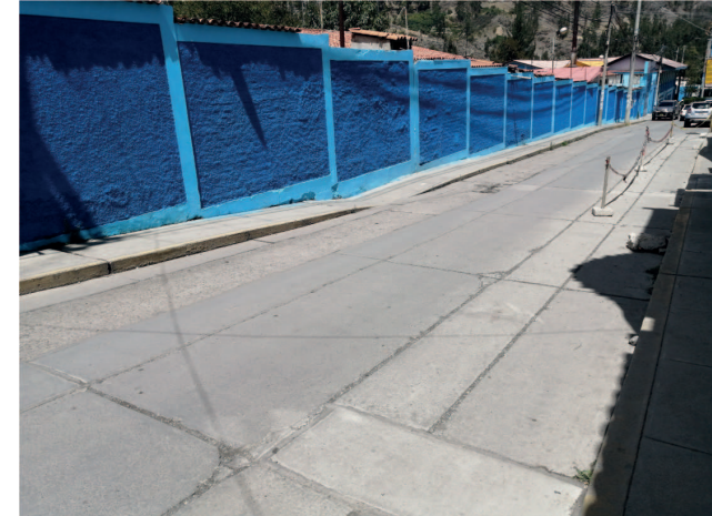
Pista con obstáculos de piedras en los bordes, cercos puestos por los vecinos y huecos en algunas partes
