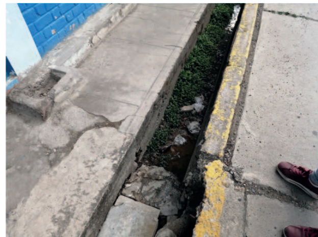
Desechos plásticos en el sector de alcantarillado en el pasaje Sarita Colonia
