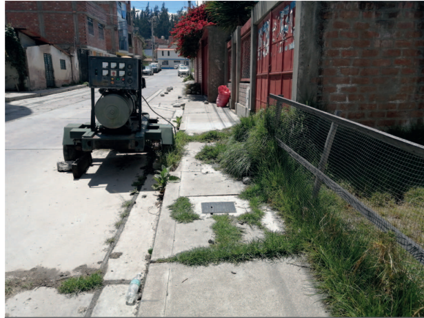
Veredas en el pasaje Sarita Colonia obstaculizado por vegetación crecida en su estructura
