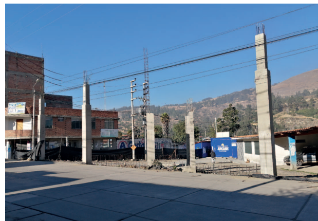
Pista de la avenida Independencia en límite con la segunda puerta del Gobierno Regional afectada por los aceros de cimentación dejados por la obra abandonada
