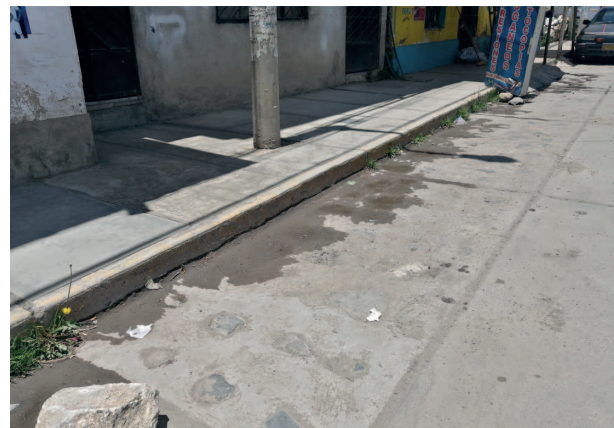
Señalización de zona rígida desgastada en la avenida Independencia
