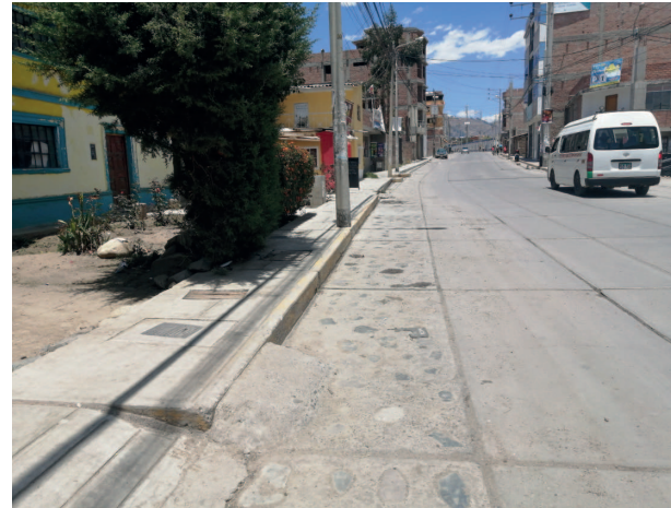
Señalización de zona rígida desgastada frente a la segunda puerta del Gobierno Regional
