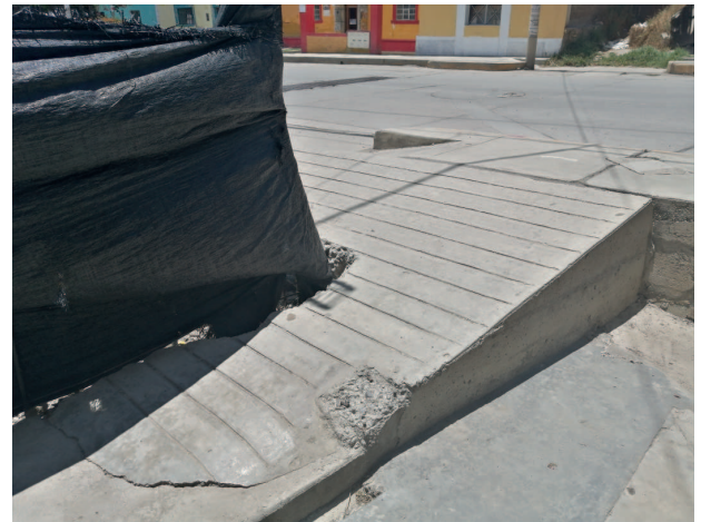
Rampa en la segunda puerta del Gobierno Regional con una parte destruida por la cimentación de la obra abandonada
