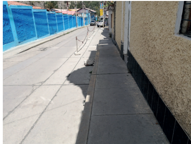
Pista con obstáculos de piedras en los bordes, cercos puestos por los vecinos y huecos en algunas partes
