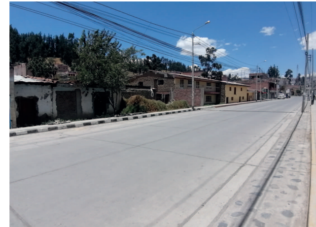
Pista en el tramo entre la Plazuela de Vichay y el Gobierno Regional en buen estado, con alcantarillado pluvial y bermas
