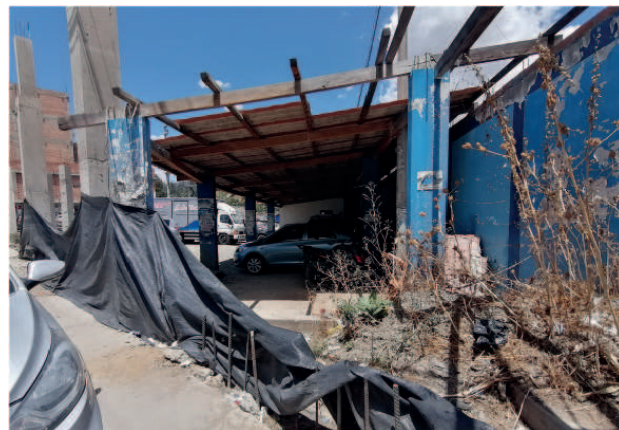
Sector del estacionamiento exterior del segundo ingreso del Gobierno Regional que se observa en mal estado de conservación y es utilizado como botadero de desechos
