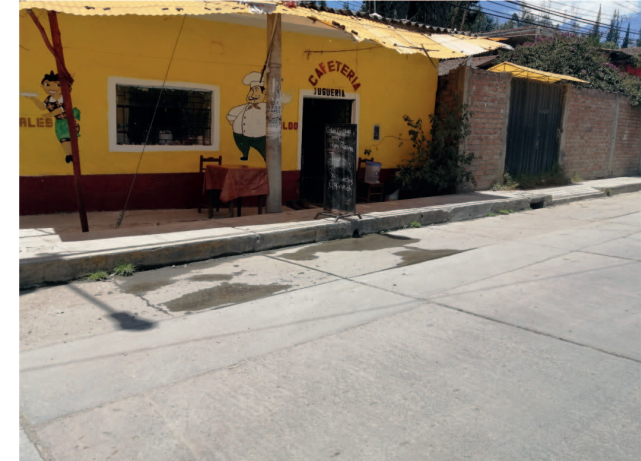
Señalización de zona rígida con desgaste en la pintura en la avenida Independencia
