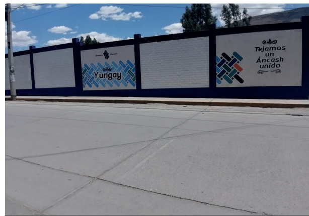
Zona rígida en el tramo de muro perimétrico del Gobierno Regional en la avenida Independencia
