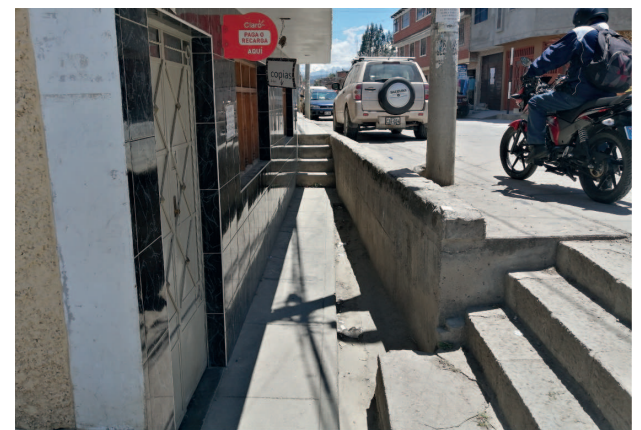
Escalones de circulación hacia el predio en la esquina entre el pasaje Sarita Colonia y la avenida Independencia
