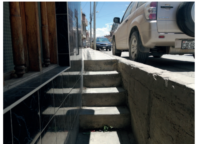
Tramo en depresión de vereda en el cruce entre el pasaje Sarita Colonia con la avenida Independencia
