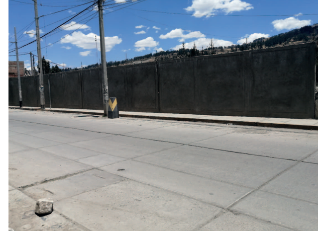
Señalización de zona rígida en la vereda del muro perimétrico del Gobierno Regional
