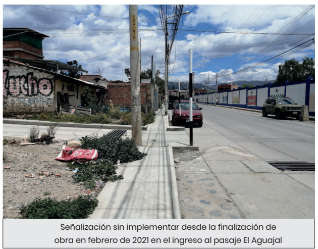
Señalización sin implementar desde la finalización de obra en febrero de 2021 en el ingreso al pasaje El Aguajal
