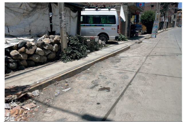
Señalización de zona rígida en la avenida Independencia
