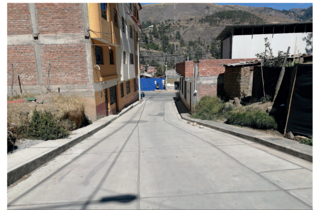
Ingreso al pasaje frente a la primera puerta del Gobierno Regional en buen estado y cortes por instalaciones de gas natural
