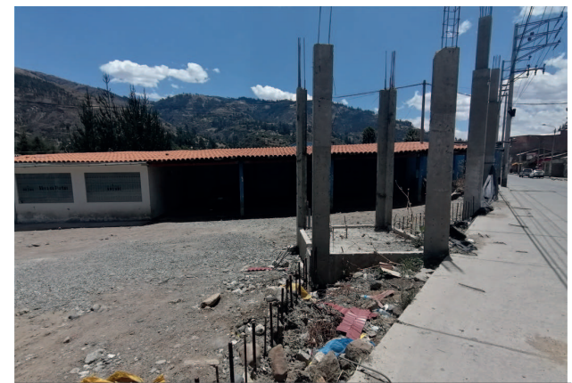
Ausencia de veredas en la segunda puerta del Gobierno Regional con fierros expuestos, desechos y fierros incrustados en la pista
