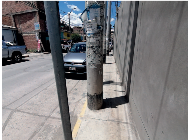
Postes de extensión eléctrica ubicados en plena vereda limitando la accesibilidad
