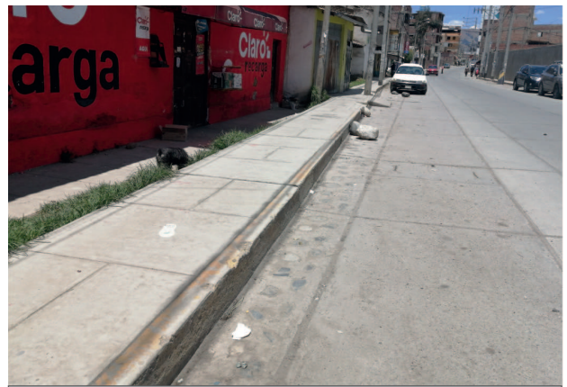
Señalización de zona rígida desgastada en la avenida Independencia
