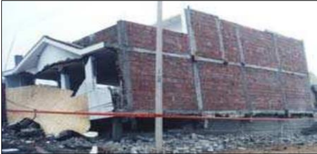
Figura 3. Colapso de vivienda debido a la baja densidad de muros en la dirección de la fachada; sismo del año 2001 en la zona sur del Perú. Fuente: Cerrón (2004)
