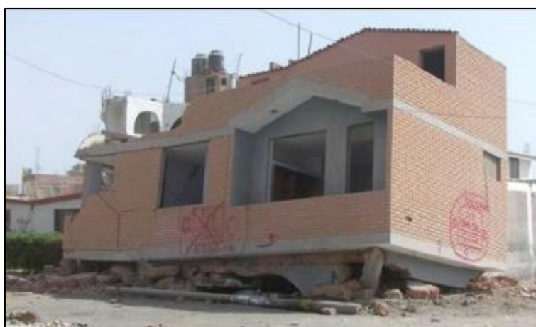
Figura 1. Discontinuidad de elementos estructurales. Fuente: Páez, Zabala y Rodríguez (2017)
