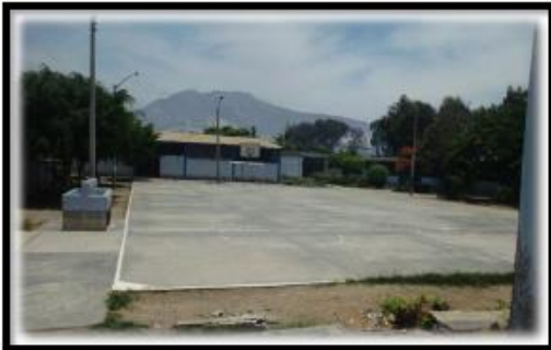
Figura 05 – Estado actual de losa deportiva.
