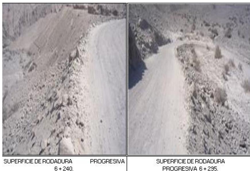
Figura 5. Curvas cerradas sin presencia de guardavías
