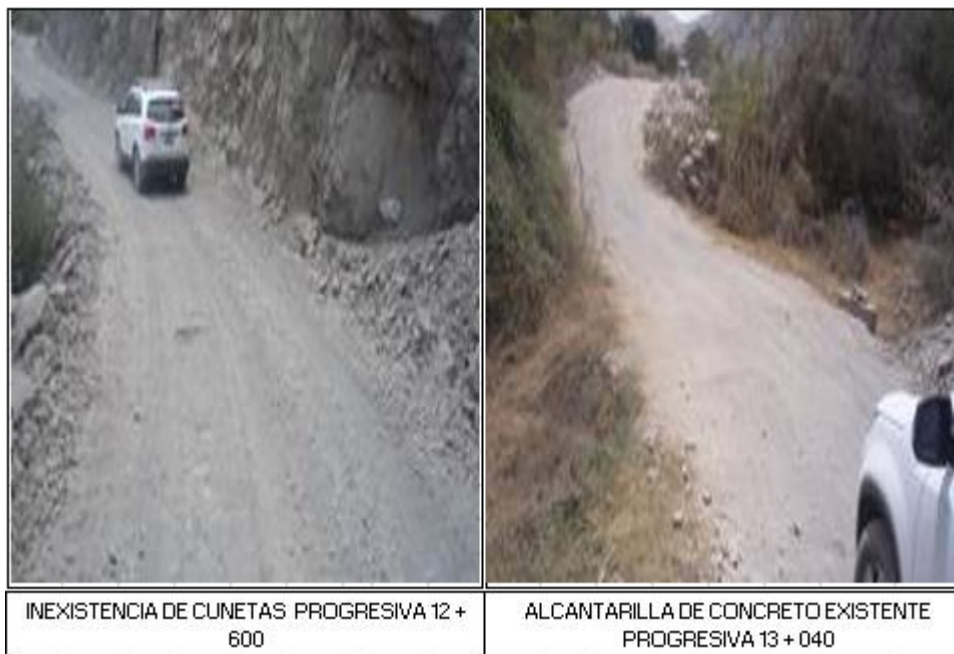
Figura 7. Vista de alcantarillas y ausencia de cunetas
