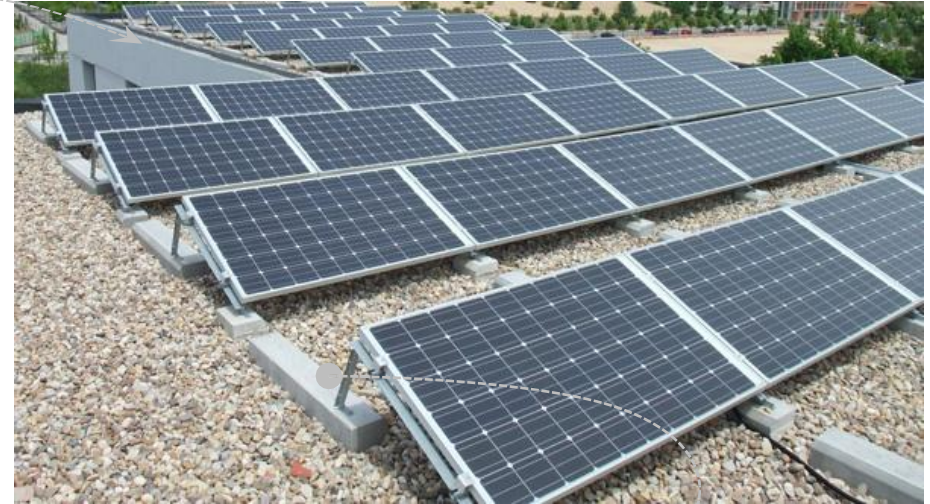
DETALLE DE PANELES SOLARES
