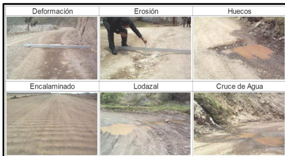
Figura 12. Tipos de daño en carreteras no pavimentadas
