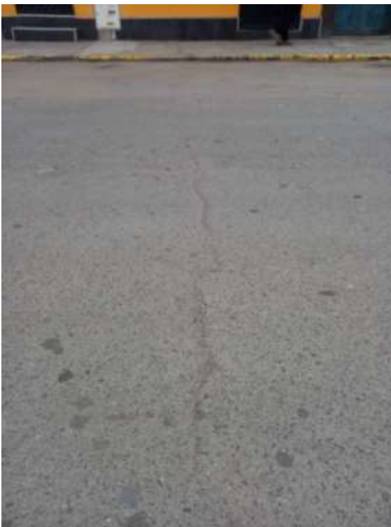
Fotografía 05: Grietas longitudinales y transversales
