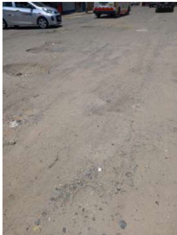
Fotografía 09: Desprendimiento de agregados
