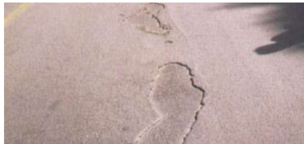
Figura 21. Desprendimiento del asfalto
