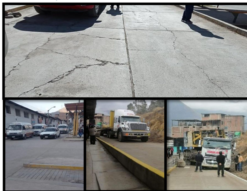
Figura 6. Calles de la Provincia de Canta con desperfectos
