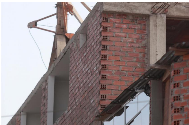
Figura 1. Construcción de Vivienda en Ate con ladrillo pandereta Fuente: Diario el comercio Lima Perú
