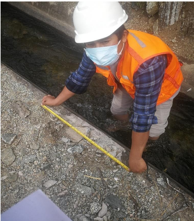
Fotografía 6. Midiendo la rotura de borde
