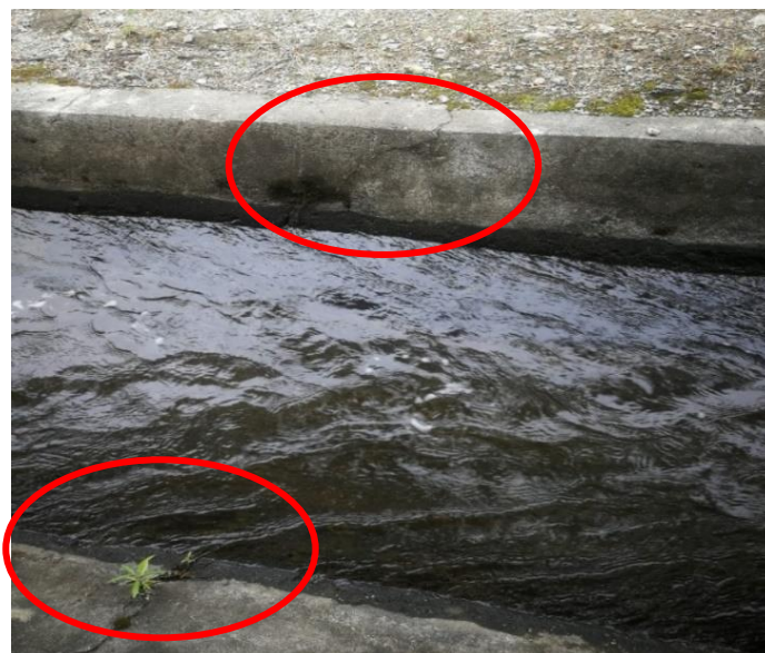
Figura 3.4. Grieta en la pared del canal
