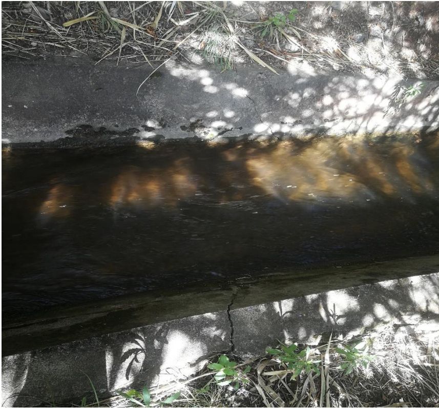
Fotografía 2. Grietas en el canal
