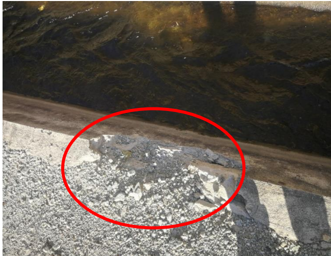
Figura 3.3. Rotura de borde del canal
