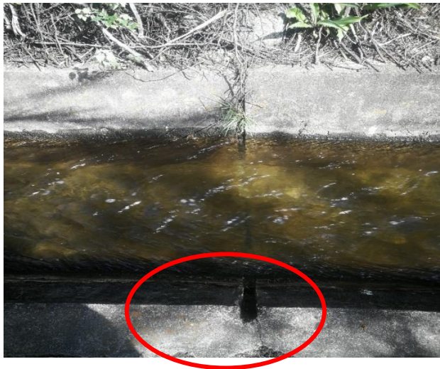
Figura 3.5. Desprendimiento del sello de junta
