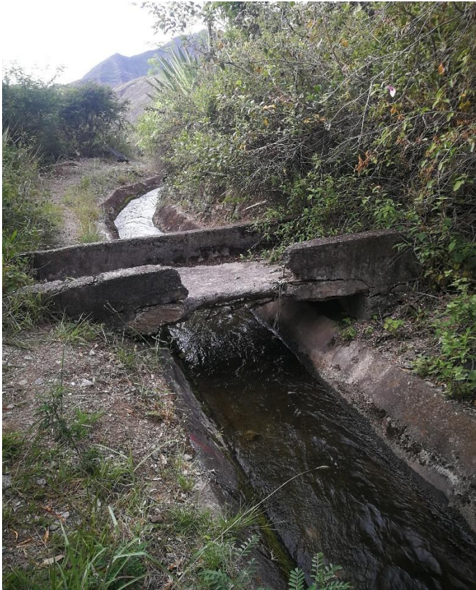
Fotografía 4. Canoa en malas condiciones
