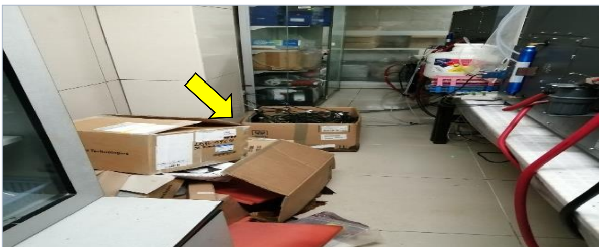
Figura 19. Falta de orden en ICP
