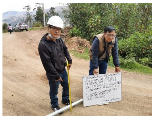
Figura 4: Evaluación de daños (km 8+500)
