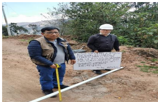
Figura 5: Evaluación de daños (km 11+250)
