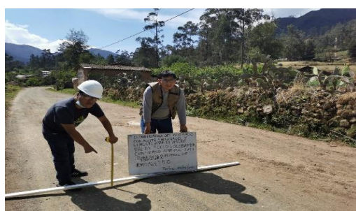
Figura 7: Evaluación de daño (km16 +750)
