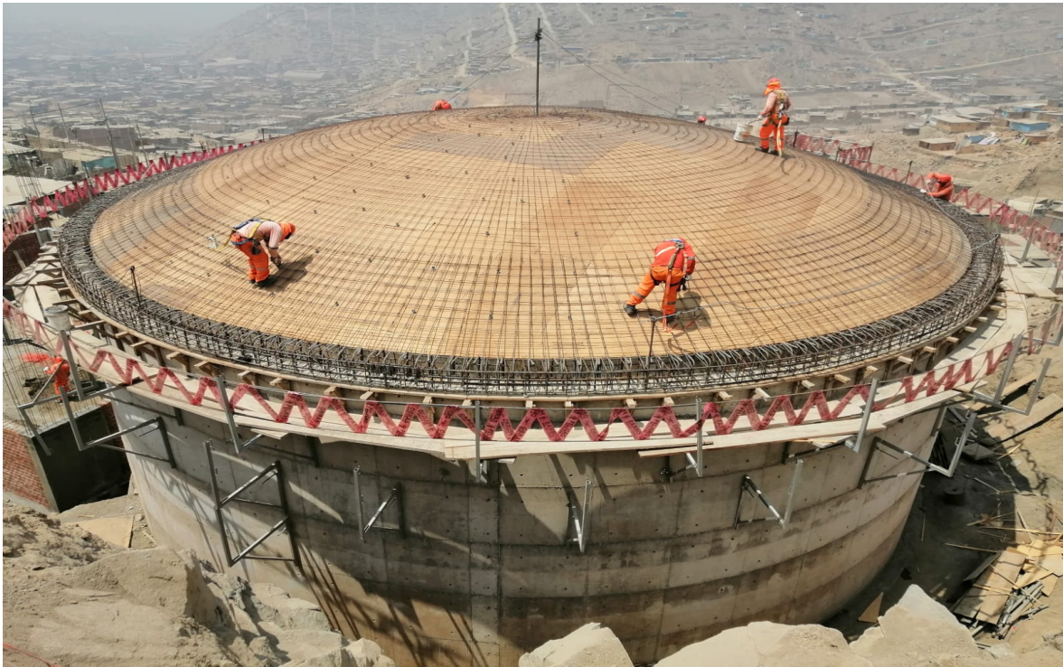
Figura 23: Reservorio de 1200 m3 del grupo Bolognesi.
