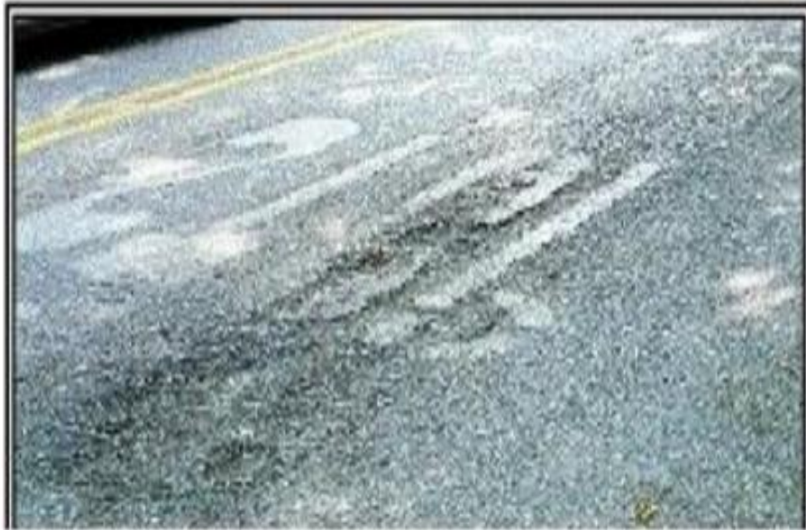
Figura N° 08 Desintegración de la carpeta
