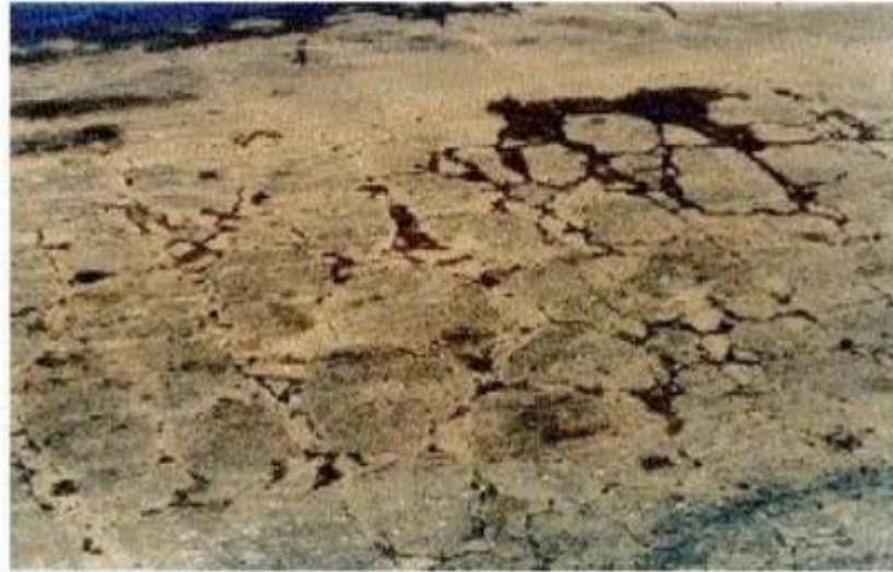
Figura N° 10 visualización de baches por fisura miento
