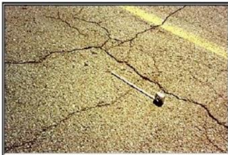
Figura N° 09 visualización de calaveras en el pavimento asfáltico
