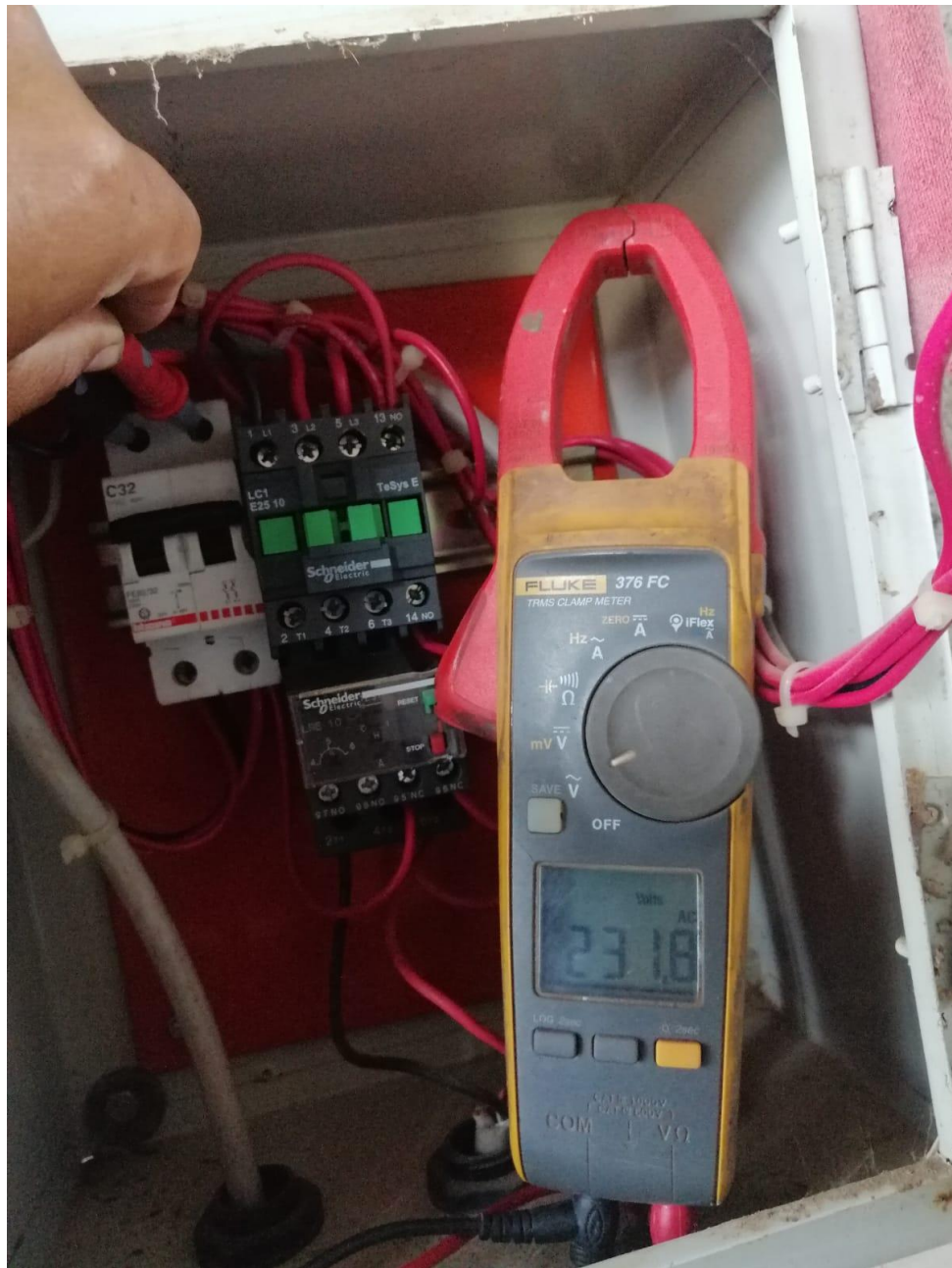
Figura 36. Identificar la causa raíz de las fallas.
