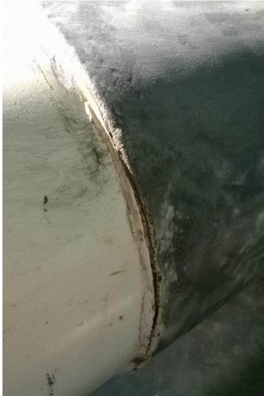
Figura 12. Descargas al no contar con niveles exactos de aislamiento Como en el caso anterior esto aumenta la criticidad de los equipos.
