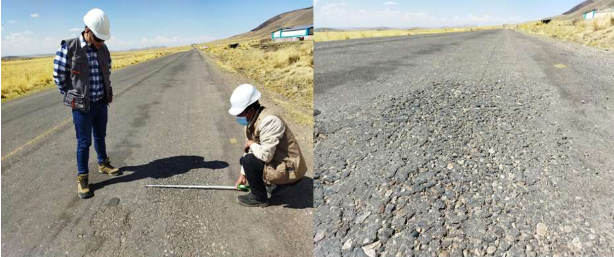
Figura 1: Fallas de la carretera Puno - Mañazo 35+00km al 39+00km.
