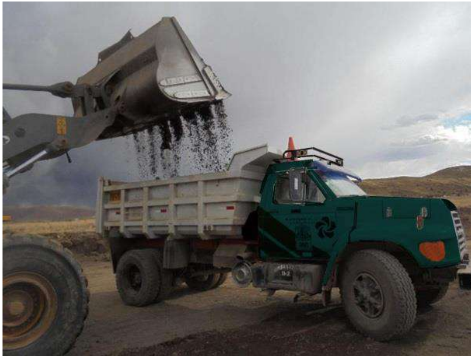
IMAGEN 6: CARGUÍO DEL CAMIÓN, CON GRAVA PARA ALCANZAR LOS 8.2TN EN EL EJE POSTERIOR.
