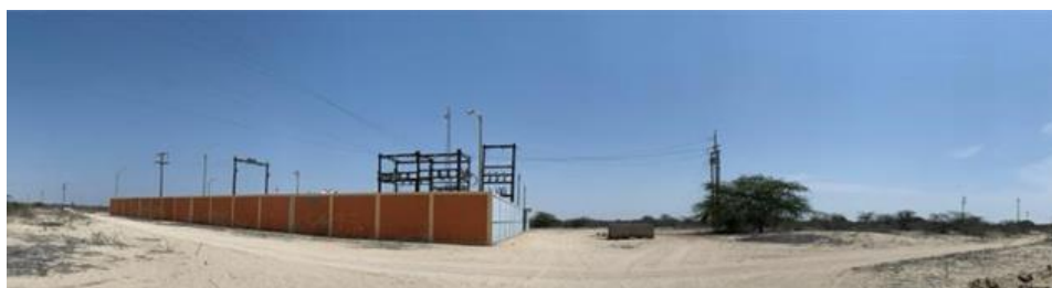
Figura 17. Exterior Sub-Estación Constante
