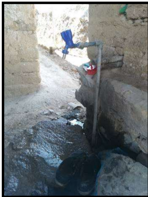
Figura 33: Vista de grifos de uso domiciliario
