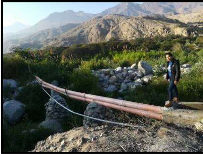
Figura 13: Vista de pase aéreo, con estructuras rudimentarias que resultan ser las menos acordes para este servicio.
