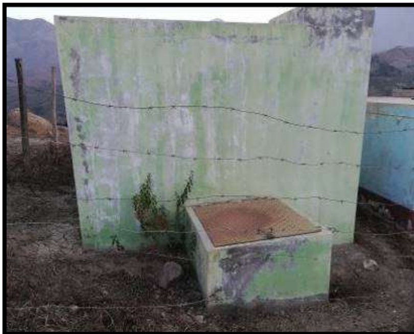
Figura 21: Vistas de las filtraciones por fisuras en los muros de la estructura
