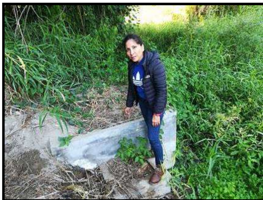
Figura 06 – La estructura fue afectada por el FEN, las cámaras húmeda y seca presentan tierra y piedras al interior.
