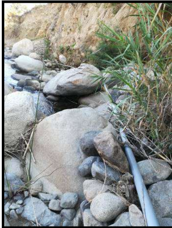
Figura 15: Se observa la línea de conducción, estando expuesta de manera riesgosa, lo que afectaría el correcto funcionamiento del servicio.
