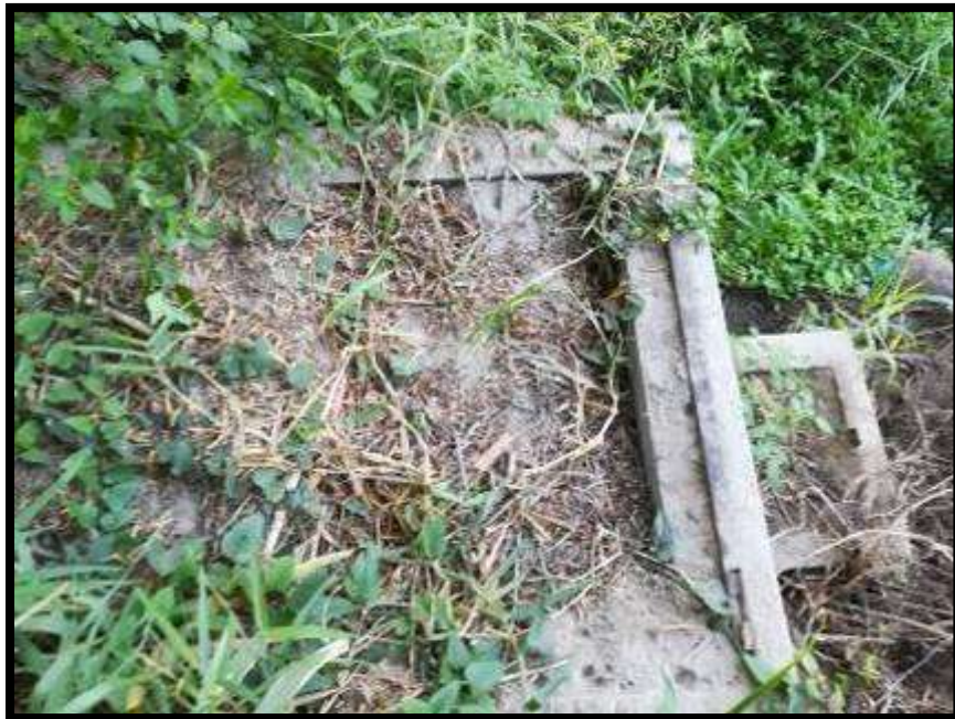
Figura 03 – Vista de la estructura de captación, totalmente colapsada y con invasión de vegetación.
