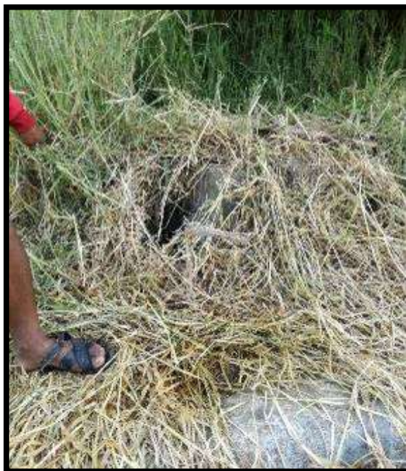
Figura 02 – Vista frontal de la estructura, la misma que está cubierta de vegetación, producto del huayco que lo afecto.
