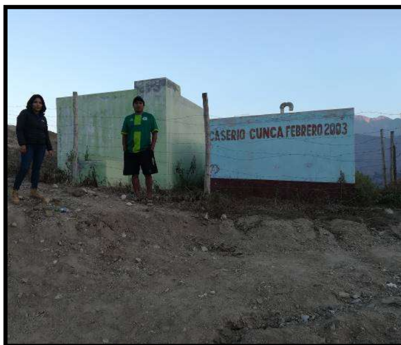
Figura 20: Verificaciones de las filtraciones por fisuras en los muros de la estructura
