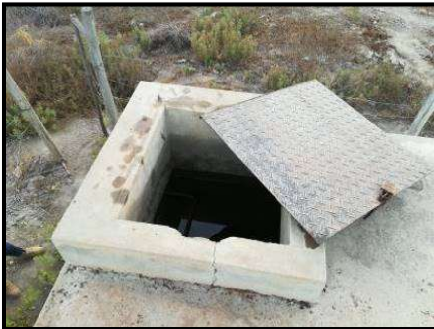
Figura 24: La tapa y contorno del ingreso a interior del reservorio, se encuentran dañados y fisurados.
