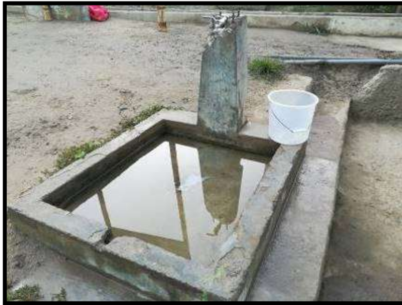
Figura 32: Vista de piletas para uso público, en el centro poblado Cunca, inoperativo.
