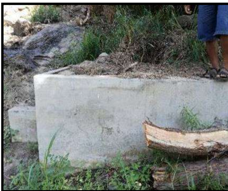
Figura 07 – Se aprecian en los muros fisuras, así como filtraciones, que afectan la estructura.
