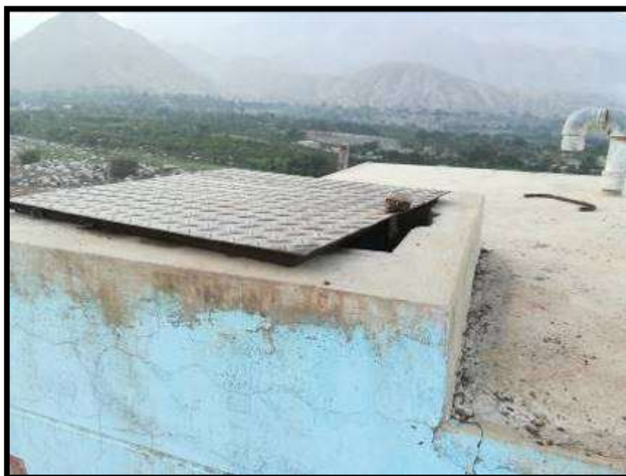
Figura 25: En la losa de techo se puede apreciar fisuras y daño en el tarrajeo.
