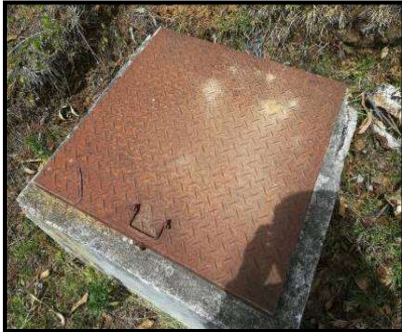
Figura 17: Caja de purga cerrada, el tarrajeo exterior dañado y la tapa de la misma se encuentra oxidada.
