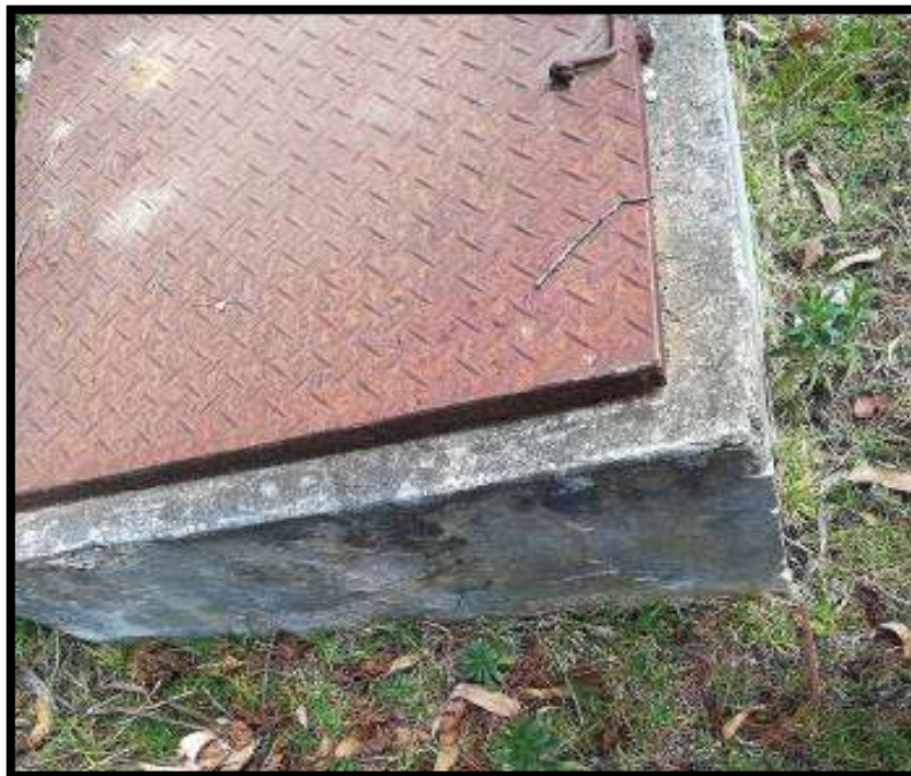
Figura 18: – Tapa oxidada no se puede acceder al interior, la chapa esta dañada.
