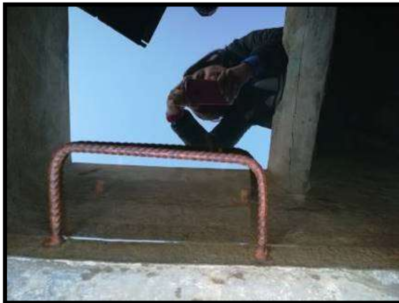
Figura 23: Los diferentes accesorios al interior del reservorio se encuentran oxidados, perjudicando la calidad del agua.
