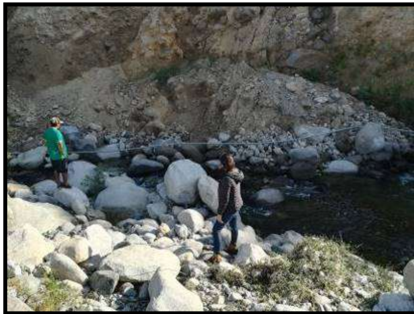
Figura 16: Vista de tubería expuesta en zona de alto riesgo.
