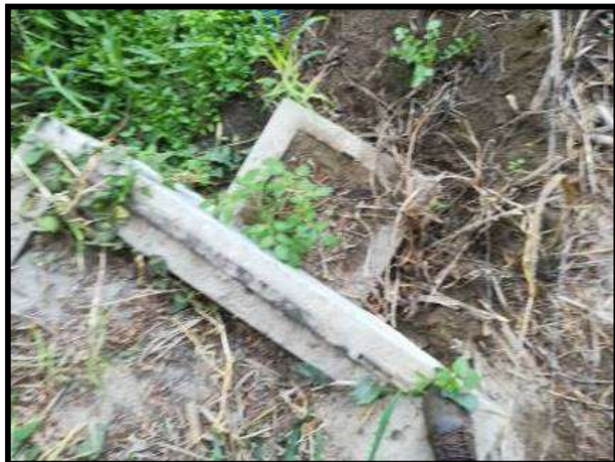
Figura 04 – Se aprecia que la captación está cubierta de tierra y lodo, producto de eventos anteriores.
