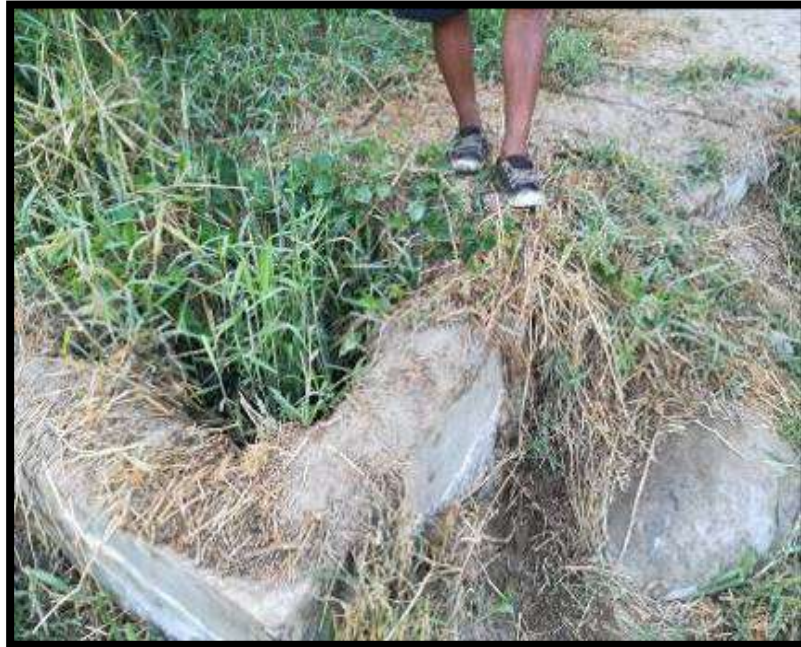
Figura 12 – El daño de la estructura está oculta por tierra y vegetación (rajaduras y fisuras)
