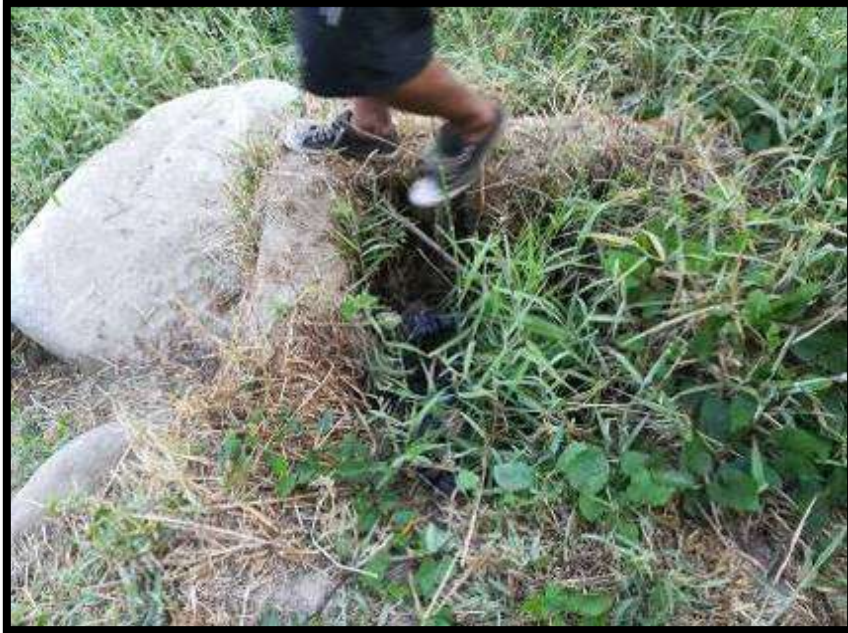
Figura 10 – La flora y fauna han invadido el terreno, habitando y transitando por las cámaras de la estructura.
