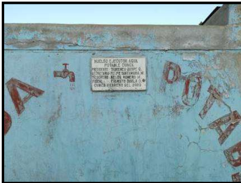
Figura 26: Los muros de la estructura presentan fisuras y filtraciones en las mismas
