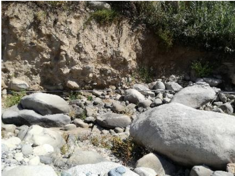
Foto 10. Tubería expuesta que requiere protección
