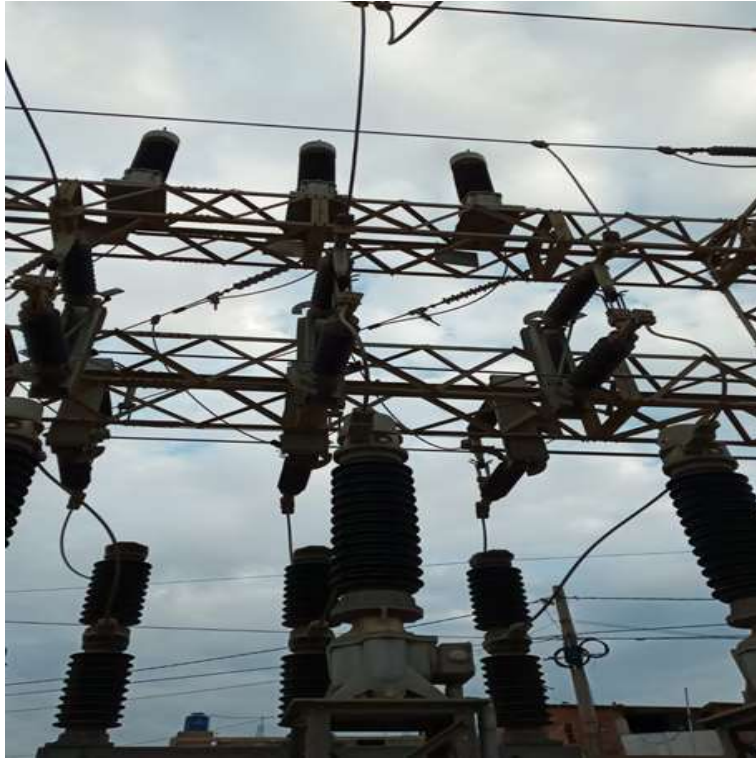
Seccionador de barra de 6 kV
