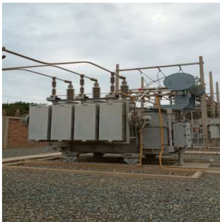
Transformador de potencia de 7MVA
