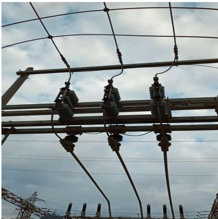
Seccionador de barra de 10 kV
