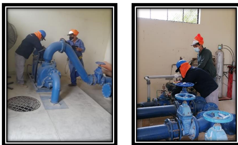
Figura Nº 10: Ajuste de faja de transmisión y bridas de descarga Fuente: Planta de tratamiento de agua – UNP.
