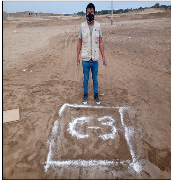
Figura 10: Ubicación de calicata N° 3
