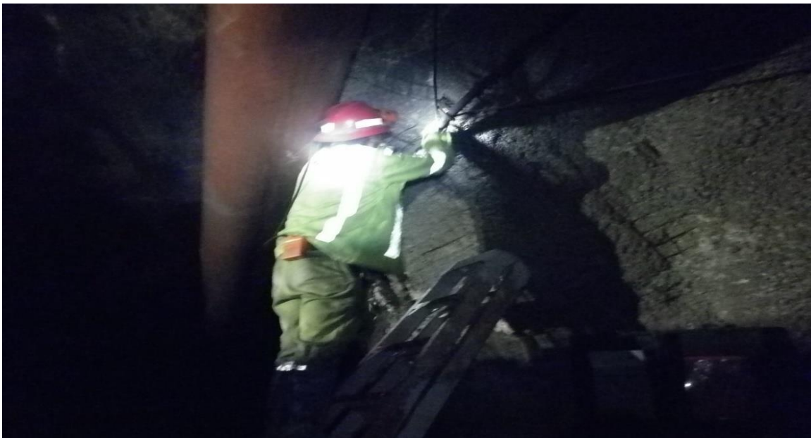
Figura 18. Evidencia del peligro o riesgo del trabajador
