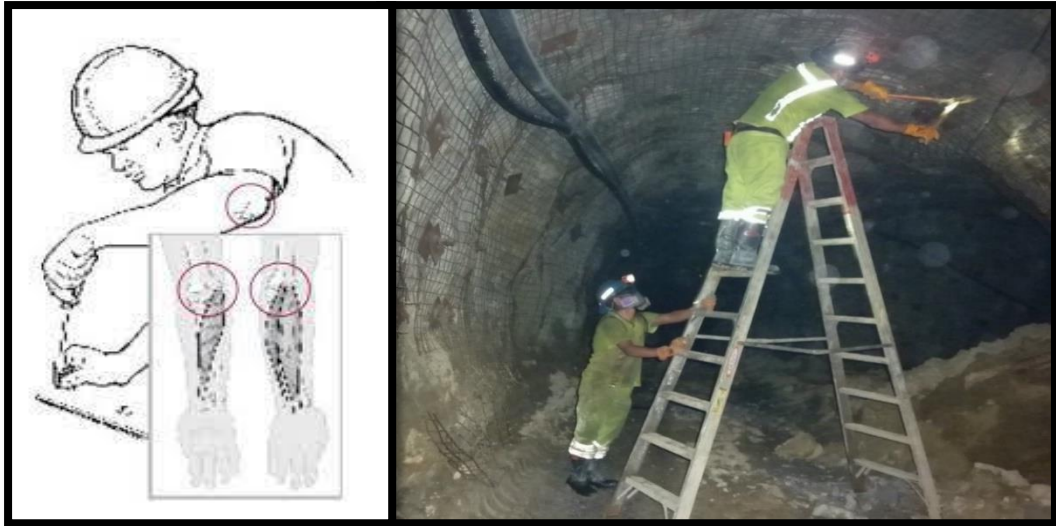
Figura 27. Problemas por actividades de corte
