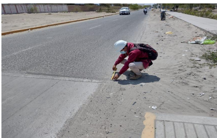
Figura N°2.-Fallas presentes- Tramo 1-(0+000 – 0+032)
