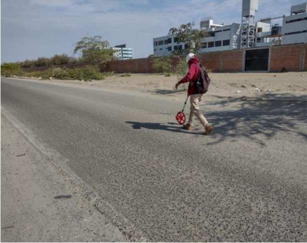
Figura N° 67: Desprendimiento de agregados
