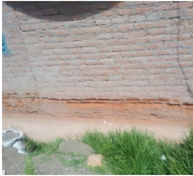
Fotografía 1. Pared de ladrillos artesanales en estado de descomposición
