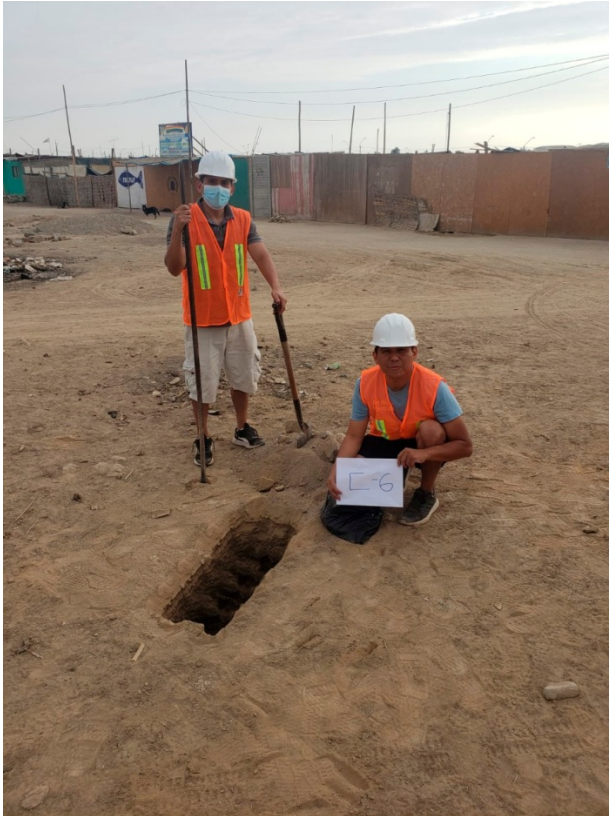
Foto 24. Excavación de la calicata N° 06 para la extracción de la muestra en el AA.HH. 15 de Agosto
