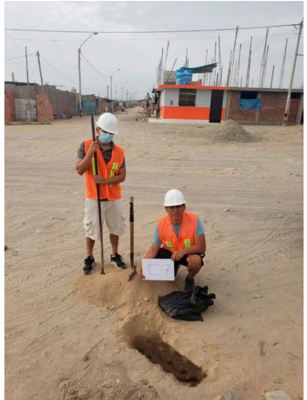
Foto 25. Excavación de la calicata N° 07 para la extracción de la muestra en el AA.HH. 15 de Agosto
