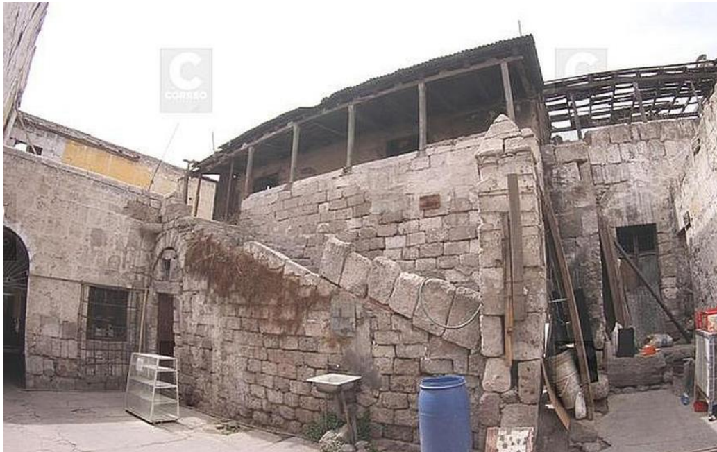
Degradación Tambo Ruelas
