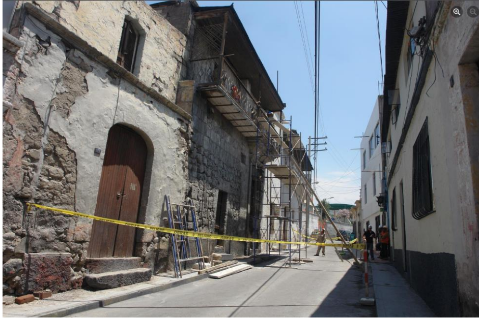
Fachada en deterioro Centro Histórico
