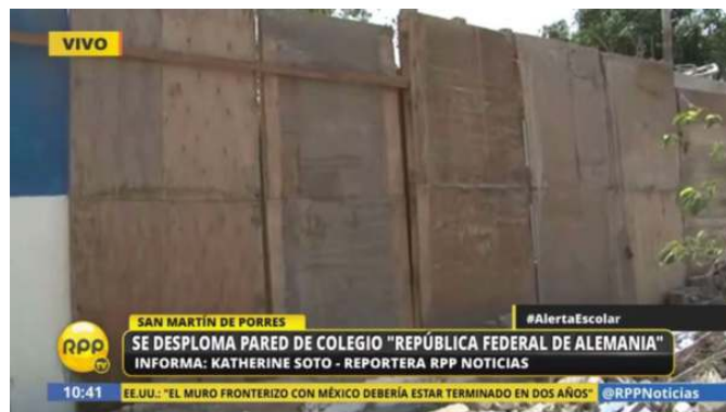
FIGURA 3: Muro de esteras improvisado por los propios vecinos para mantener la seguridad dentro del colegio república federal de Alemania , imagen disponible en: http://rpp.pe/lima/actualidad/se-desplomo-la-pared-de-un-colegio-en-san-martin-de-porres-noticia-1028082
