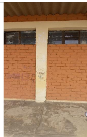
Figura 29. Columna sin continuidad del módulo 1
