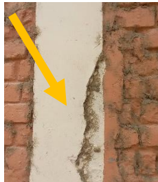
Figura 17. Desprendimiento en columna de Módulo 2
