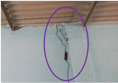
Figura 16. Grieta en muro de módulo 2
