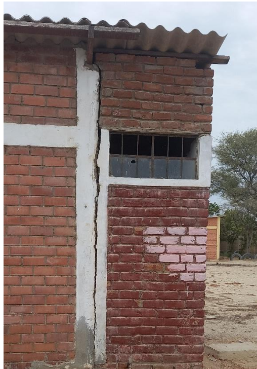
Figura 67. Fisuras y grietas
