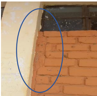
Figura 13. Fisura en muro de módulo 1
