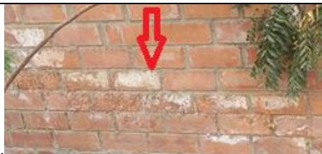
Figura 27. Disgregación de muro en módulo 5
