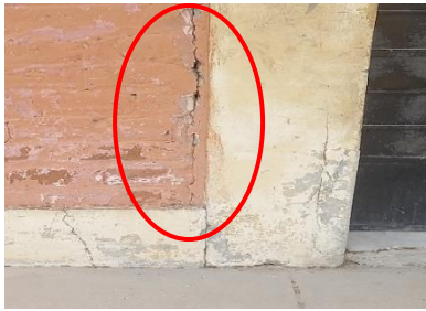
Figura 15. Fisura en muro de módulo 2
