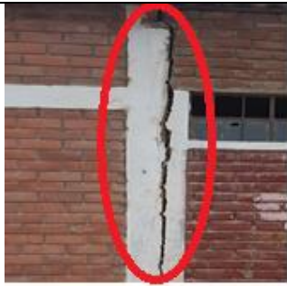
Figura 25. Grieta en columna del módulo 5
