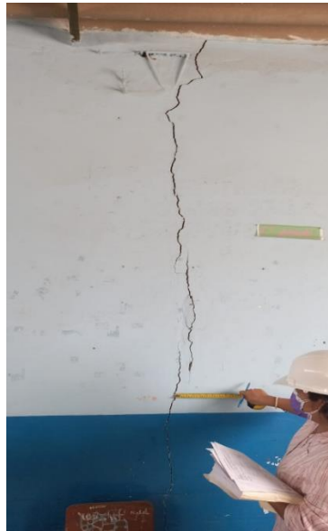
Figura 66. Fisuras y grietas en módulo 2
