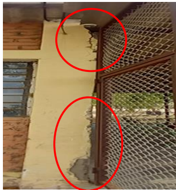
Figura 14. Desprendimiento en muro de módulo 1
