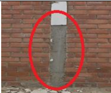
Figura 26. Desprendimiento en columnas de módulo 5
