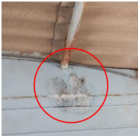
Figura 12. Humedad en muro de módulo 1
