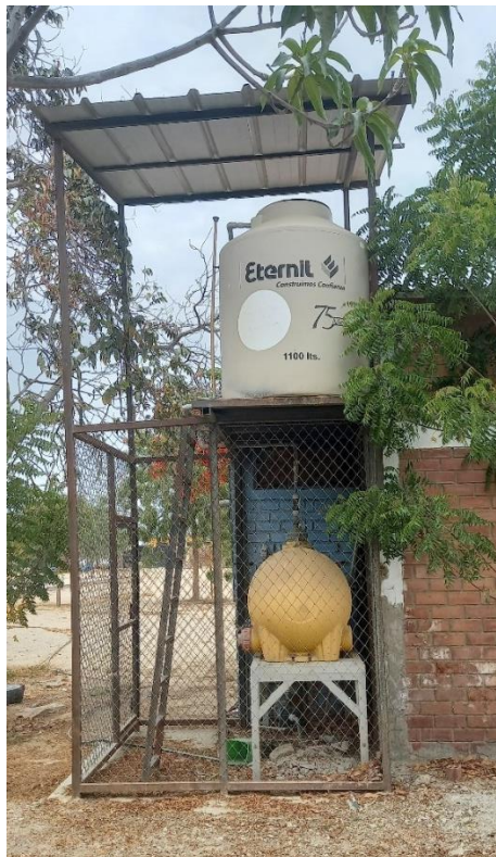
Figura 65. Tanque elevado en módulo 5
