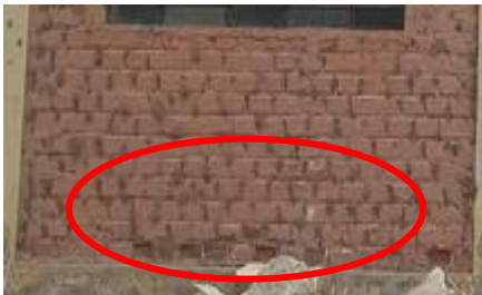
Figura 18. Disgregación en muro de módulo 2
