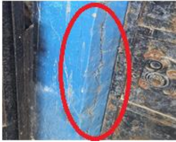
Figura 24. Fisura en columna de módulo 5
