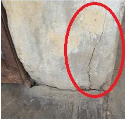
Figura 22. Fisura en columna de módulo 4
