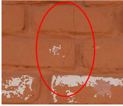
Figura 19. Fisura en muro de módulo 3
