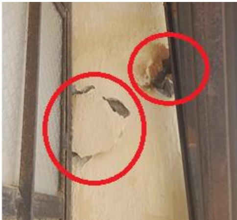
Figura 23. Desprendimiento en columnas en módulo 4
