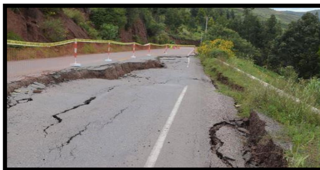
Figura 1. Falla de carpeta asfáltica en la carretera que conecta Cusco y Valle sagrado de los incas.
