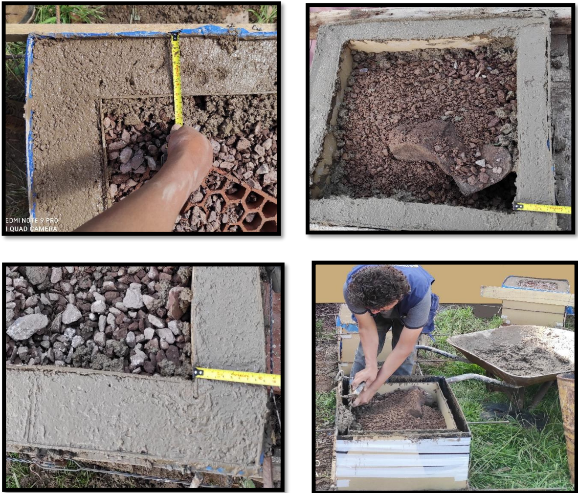
Figura 23. Vaciado y encofrado de los moldes de espesores 4 cm, 8 cm y 10 cm de espesor.
