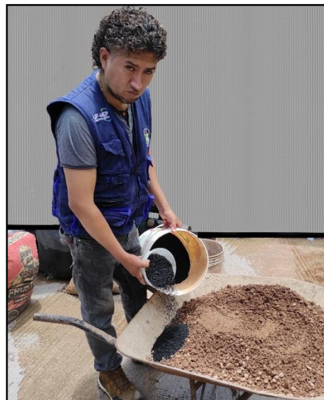
figura 20, se calcula la relación de volumen y agregado con la ayuda de baldes de 20 litros y una taza medidora.
