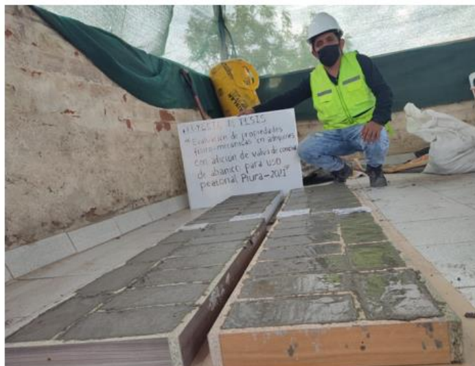
FIGURA 29: adoquines completamente vaciados
