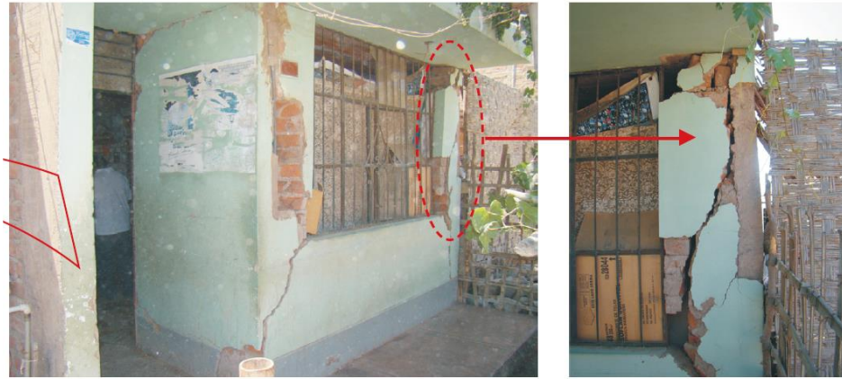
Figura 2. vivienda de albañilería dañada por el sismo de 15 de agosto de 2007
