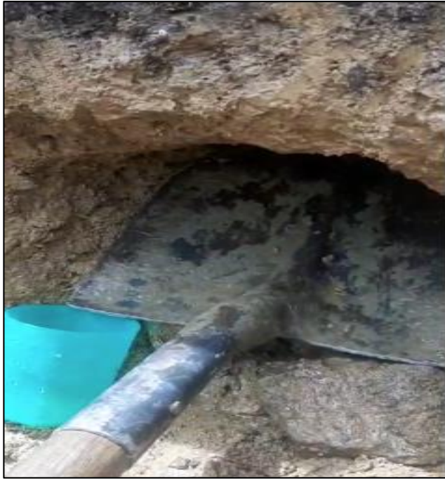
Figura 21: Acumulación del agua
