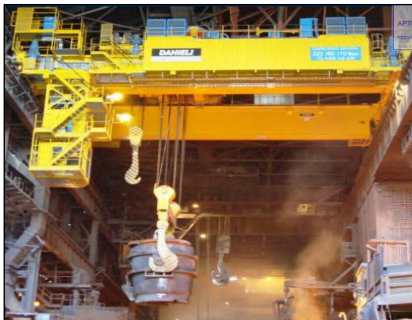
Figura 5. Grúa puente 406 DANIELI.
