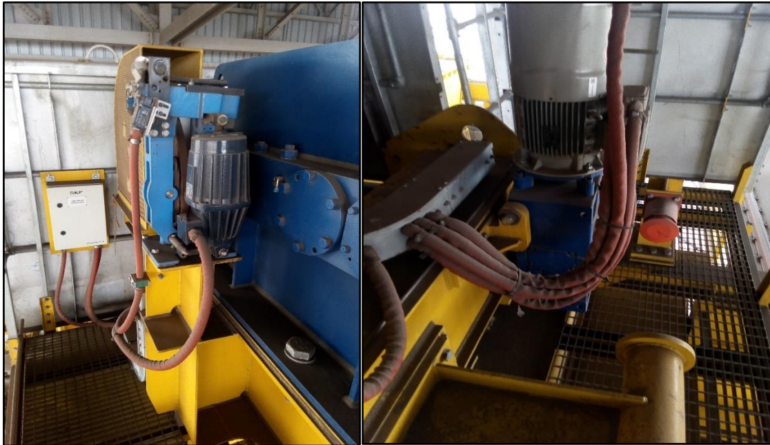
Figura 17. Cables de sistema carro.
