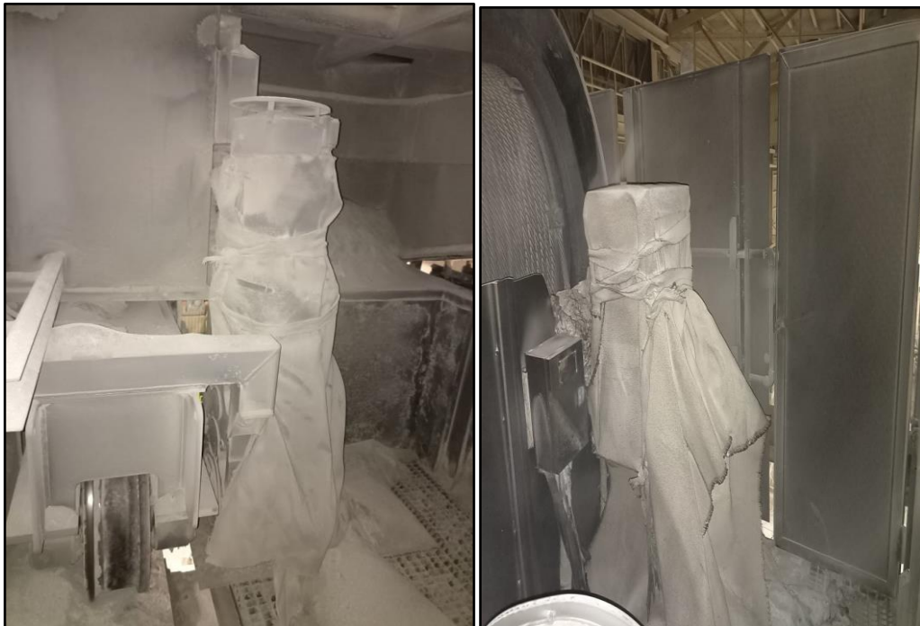
Figura 22. Motores protegidos con manta silice.
